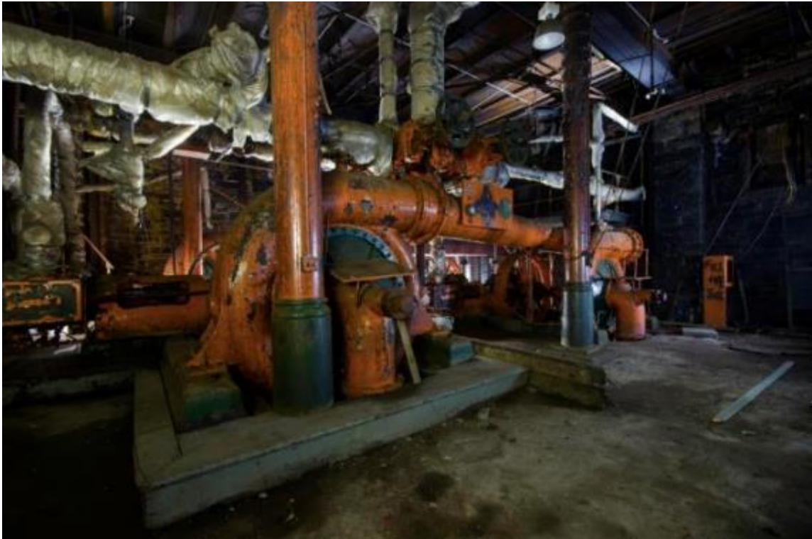
Vue générale des pompes à vapeur.
