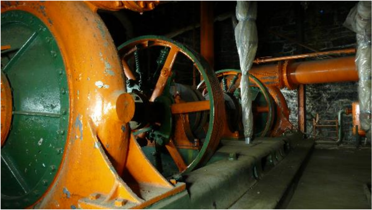
Détail des pompes à vapeur.
