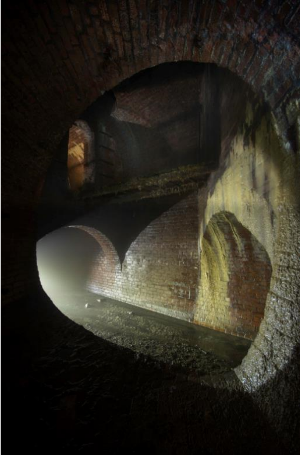
Connexion à l'égout Craig, vue à partir de l'un des canaux d'aspiration des pompes.
