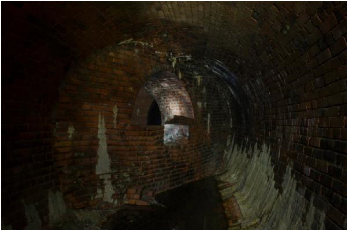
De l'autre côté du trop-plein, dans la conduite menant au collecteur sous l'avenue de Lorimier.
