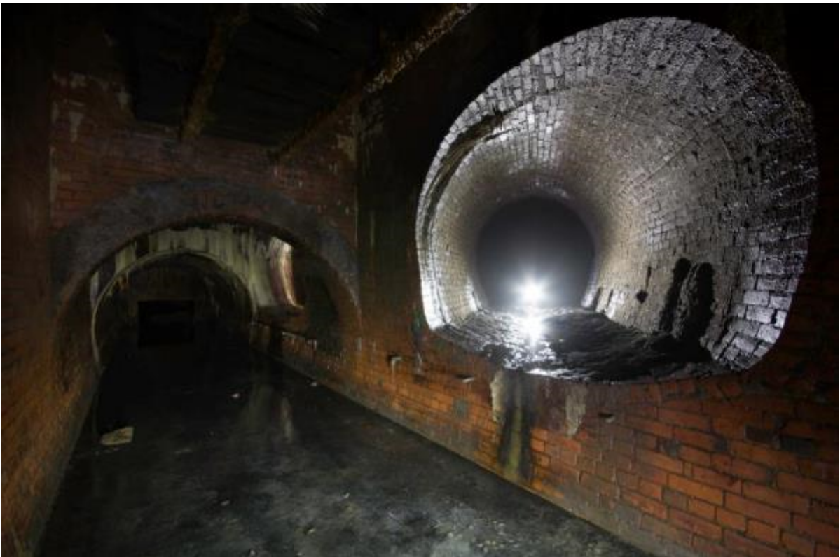
Chambre de dérivation vers les pompes; en avant-plan, un des canaux d'aspiration.
