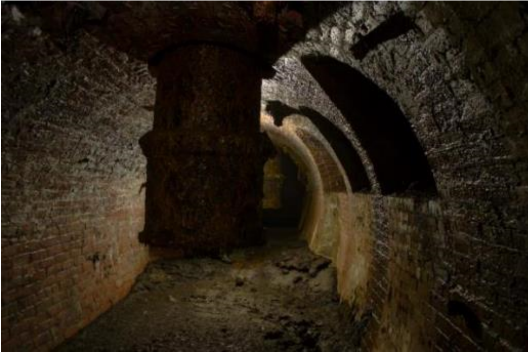
Canal d'aspiration des pompes; en avant-plan, la conduite de succion d'une des pompes.
