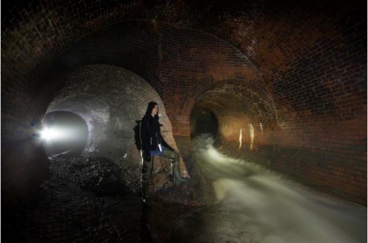
Jonction avec le collecteur Colborne sous l'avenue de Lorimier.
