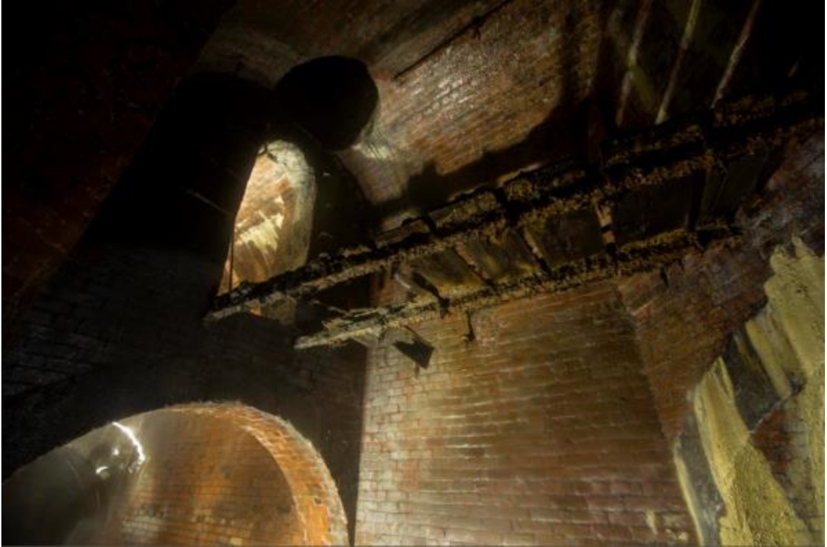
Détail d'un élément de la chambre de dérivation vers les pompes; Passerelle en bois.
