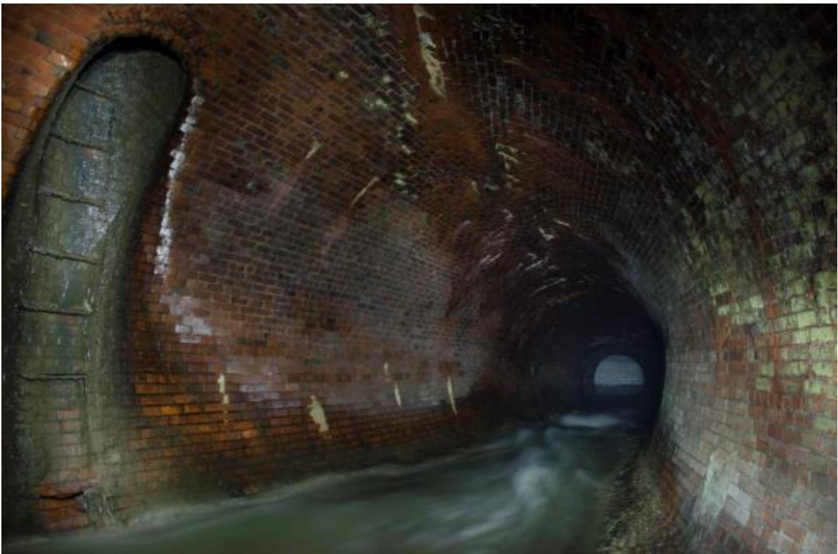
En arrière-plan, la structure de chute et dérivation vers le collecteur Lafontaine.
