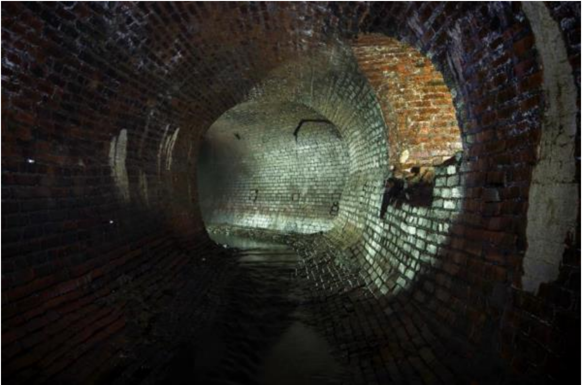
Courbe du tunnel avec, à droite, le trop-plein vers le collecteur Colborne.
