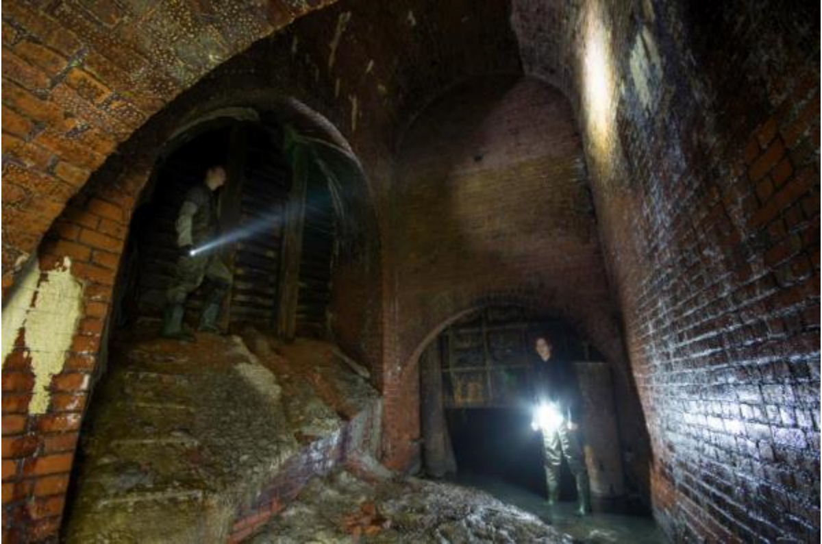
Chambre de refoulement des pompes en aval de l'écluse (à droite). À gauche, la conduite de refoulement désormais murée.
