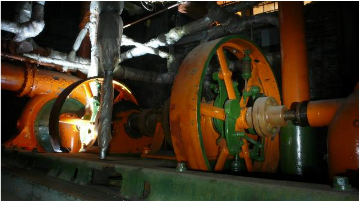
Détail des arbres de transmission des pompes.
