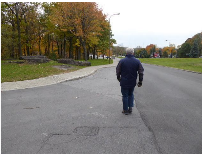
Photo 15: Conséquence du désalignement du trottoir à l'entrée des Ateliers municipaux
