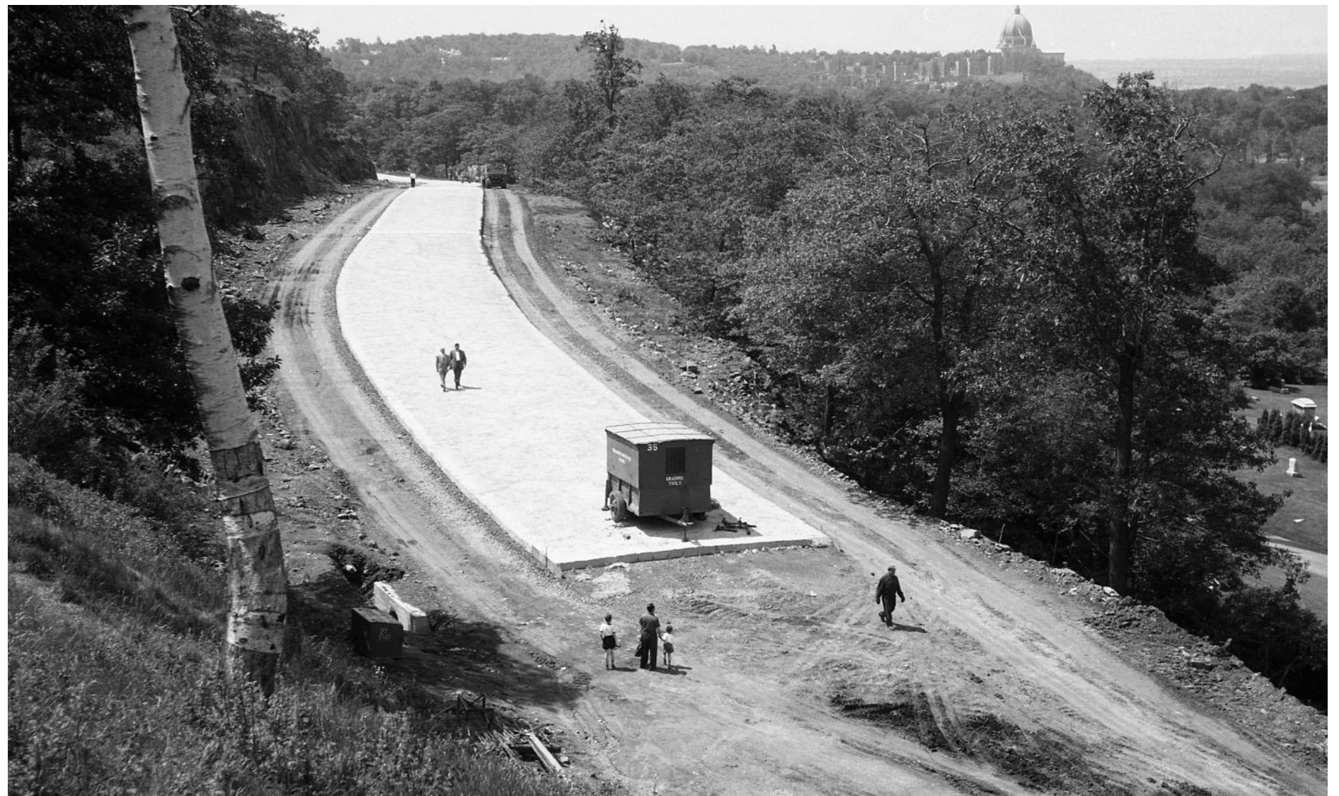
1 Le 10 juillet 1958. La route de la montagne en construction. Au bas de la route en construction, à l'entrée de l'ancien tunnel, et en contrebas, le cimetière Mont-Royal. AVM. VM105-Y-2_213-12.
