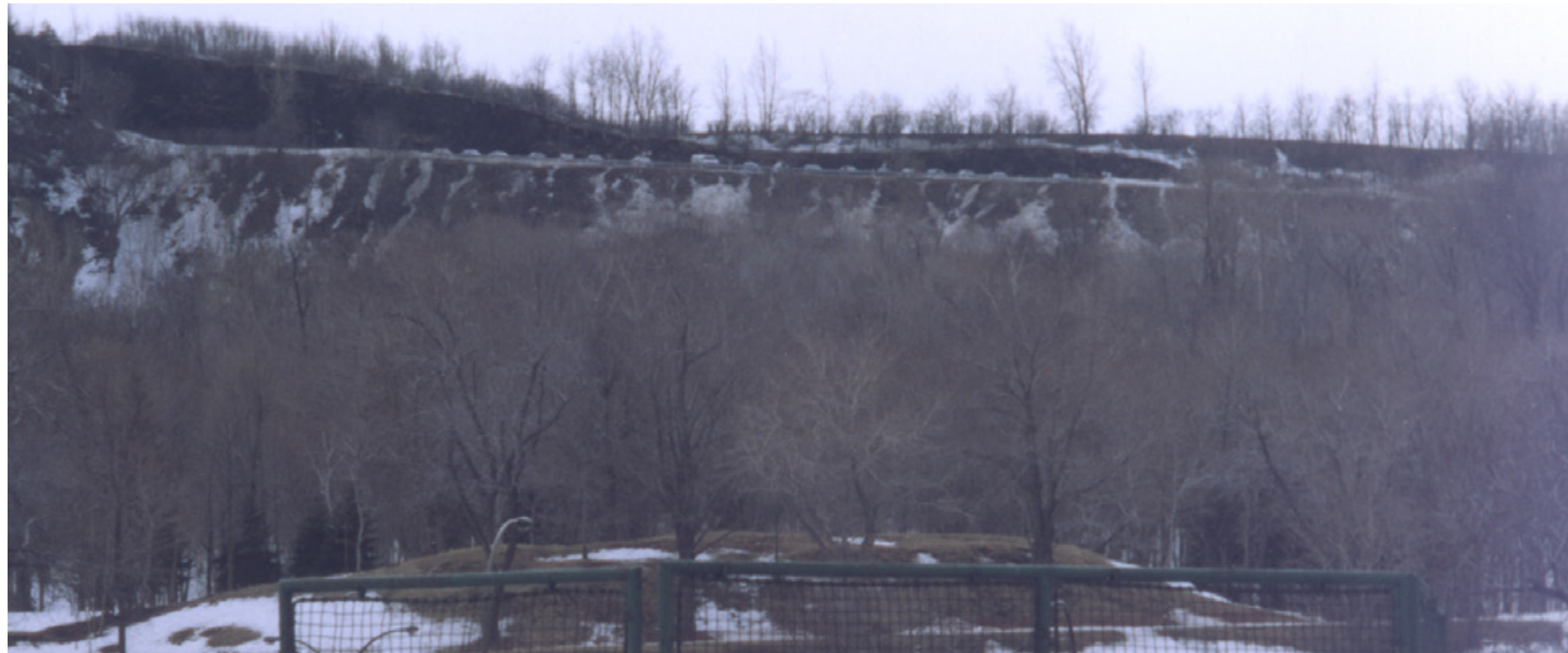
7 Avant 1995. L'érosion sur le talus du belvédère Camilien-Houde. VM. SGPVMR. 1995-avant_DOCS1-#41413-v1-J__6Ville-Marie_0200-0299_0225_Mt-Royal_Général_Visite_guidée_incluant_photos_historiques_Visite_guidée_-_Parc_MR_075-Esc_talus_CH_vue_ensemble.
