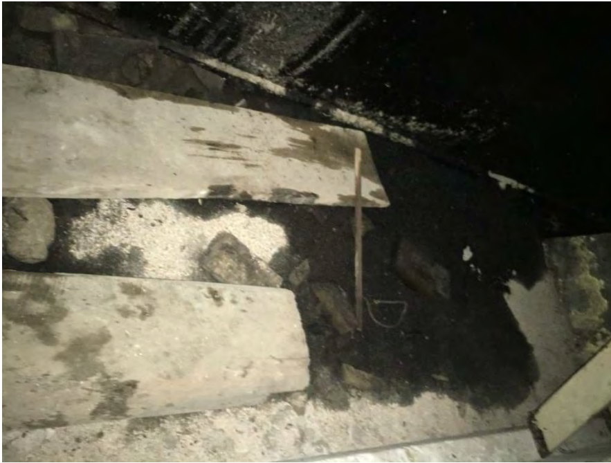
Photographie 1 : Taches au sol sous le réservoir confiné dans l'aile B
