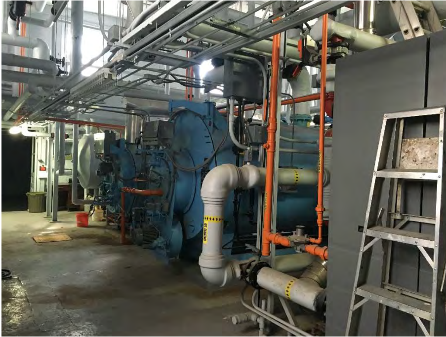
Photographie 7 : Salle des bouilloires
