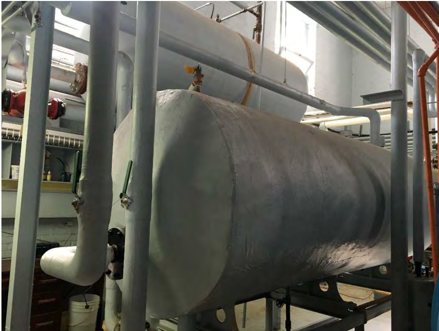
Photographies 8 : Réservoirs datant de 1928 et possiblement recouverts d'amiante
