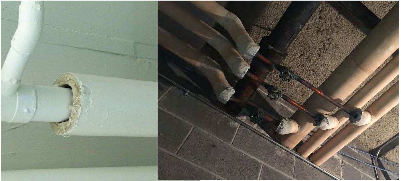
Photographie 4 : Isolant autour des tuyaux
