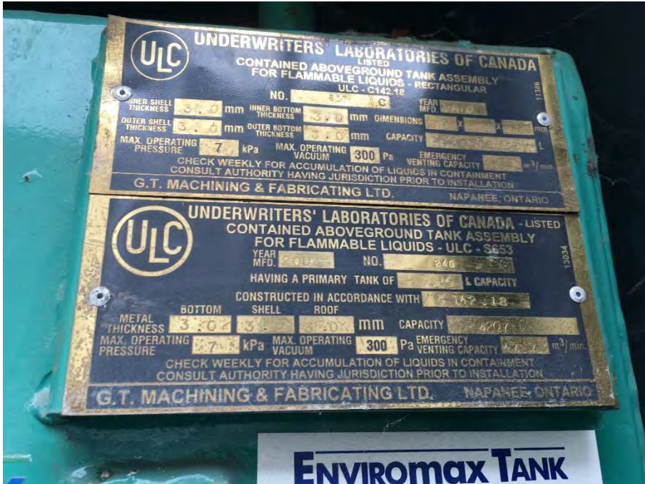
Photographie 16 : Réservoir de la génératrice
