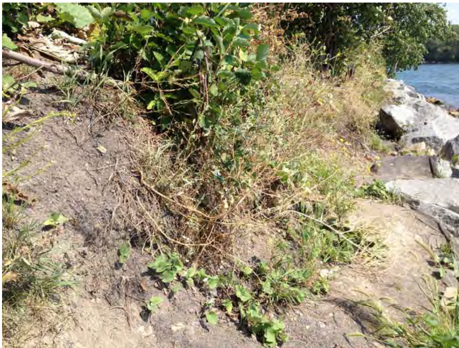
Photo 18 (05-09-2014) : Tronçon 3 – Marques d'érosion au-dessus des blocs
