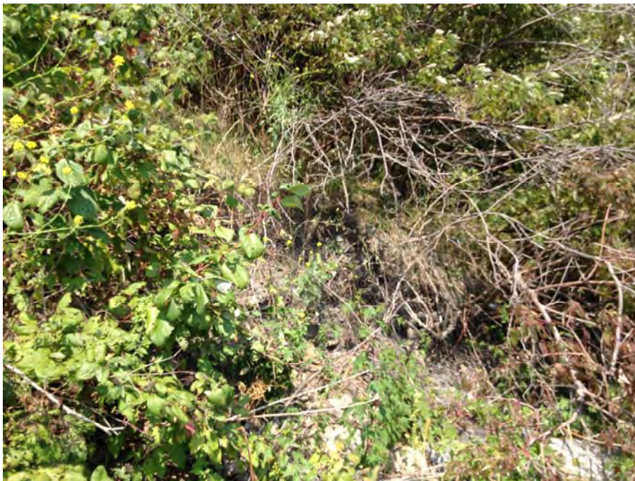
Photo 20 (05-09-2014) : Tronçon 3 – Marques d'érosion au-dessus des blocs
