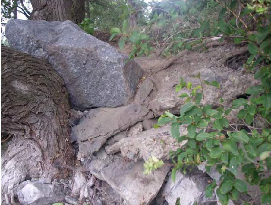
Photo 7 (05-09-2014) : Tronçon 1 - Remblai original et végétation (racines) imbriqués l'un dans l'autre
