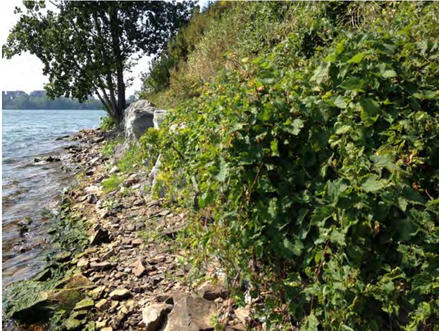
Photo 17 (05-09-2014) : Tronçon 3 - Bas de talus et accumulation de pierres
