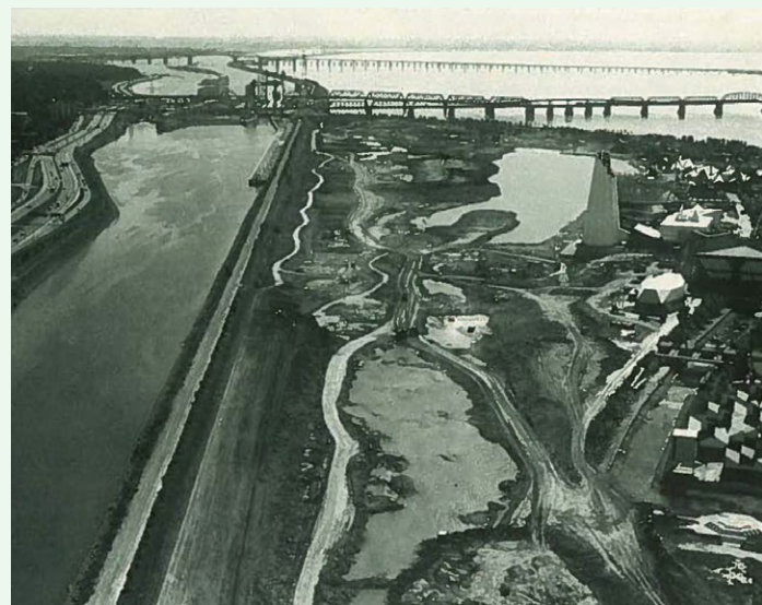
Travaux d'excavation au Bassin olympique en septembre 1974, in Rapport officiel des Jeux olympiques de 1976 - Volume II - Installations, 1978, RIO.
