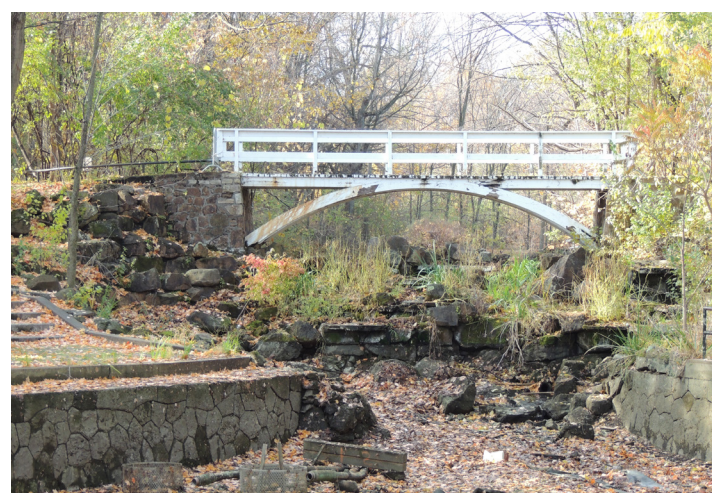
Fig. 284 : Les ponts sont en mauvais états et un d'eux est fermé au public, 2015. WAA
