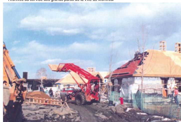
Fig. 85 : Construction des pavillons D39 et D40, [s.d.] Archives du service des grands parcs de la Ville de Montréal
