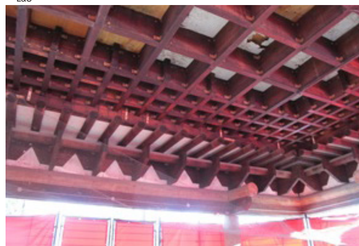
Fig. 77 : État actuel des poutres à l'extérieur, 2016 L&S
