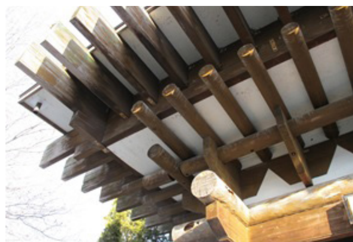
Fig. 76 : État actuel du plafond, 2016 L&S
