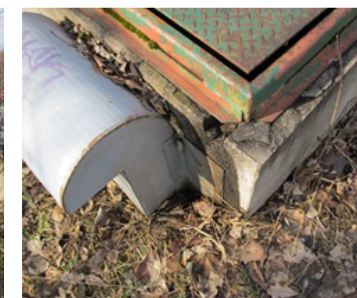
Fig. 56 : Détérioration du béton, 2016 L&S
