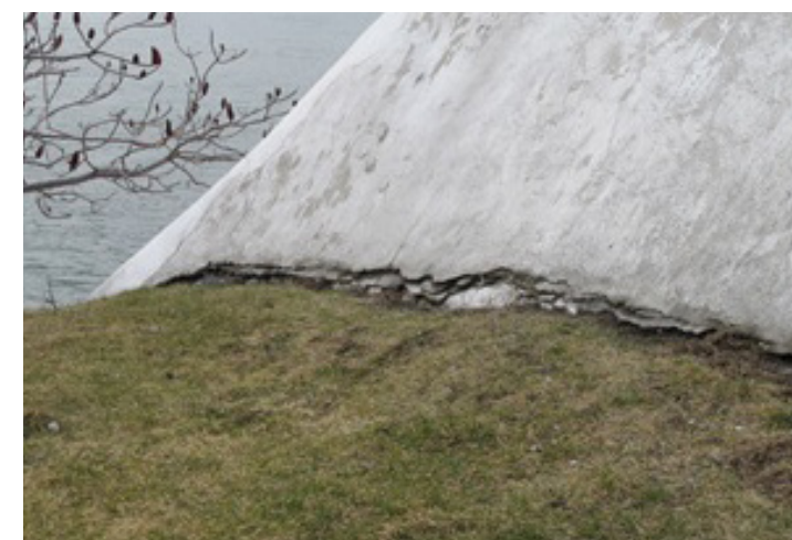
Fig. 119 : Détérioration de la base, 2016 L&S
