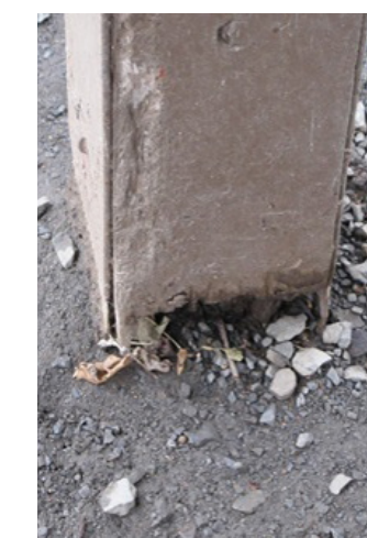
Fig. 257 : Détérioration d'une colonne de bois, 2016 L&S
