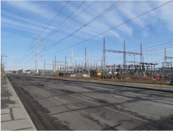
Figure 24: Poste électrique Notre-Dame
