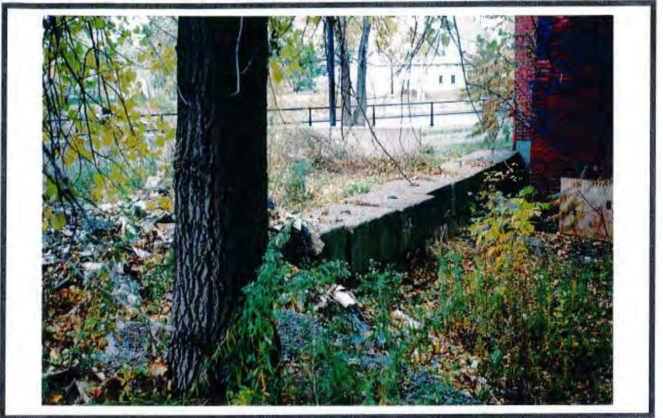
Planche # 7 : Vue de la base de la cheminée (édifice D). On observe le remblai et les déchets présents à la base.
