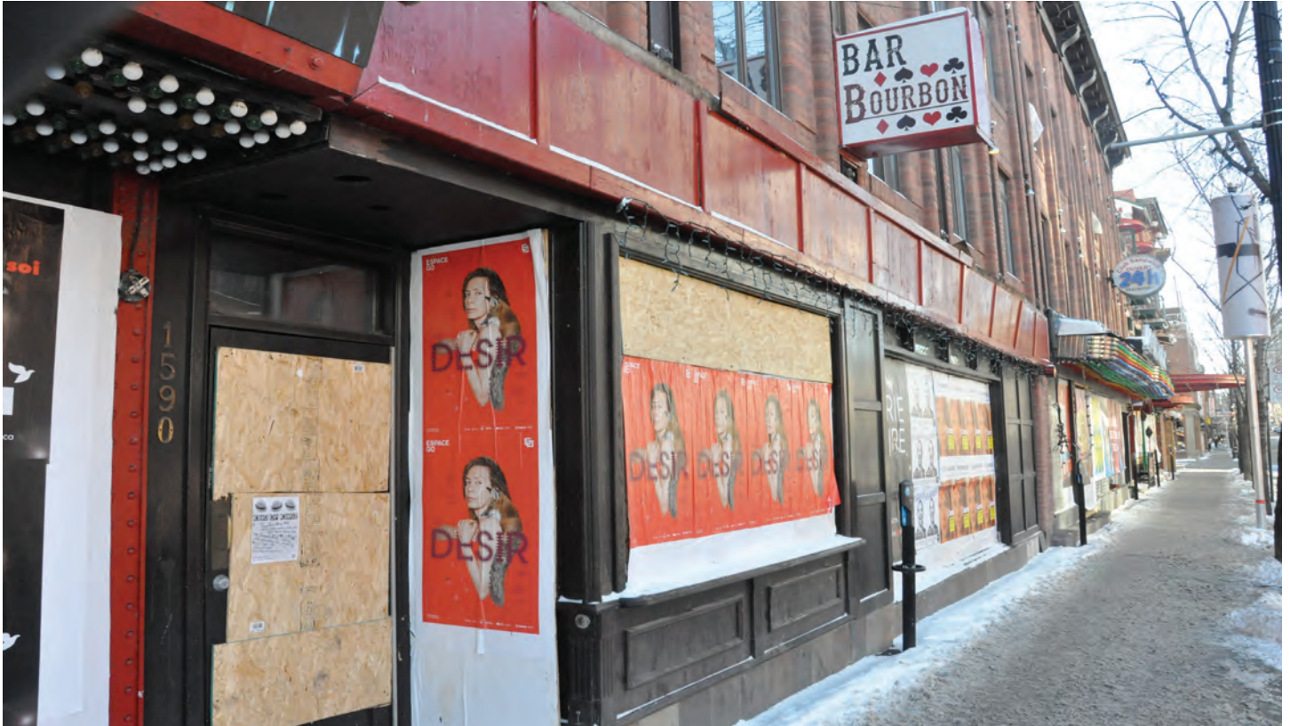
Traitement de la façade du bâtiment 1 au niveau du rez-de-chaussée. On note la diversité des types d'ouvertures, maintenant condamnées, et la présence des enseignes.
