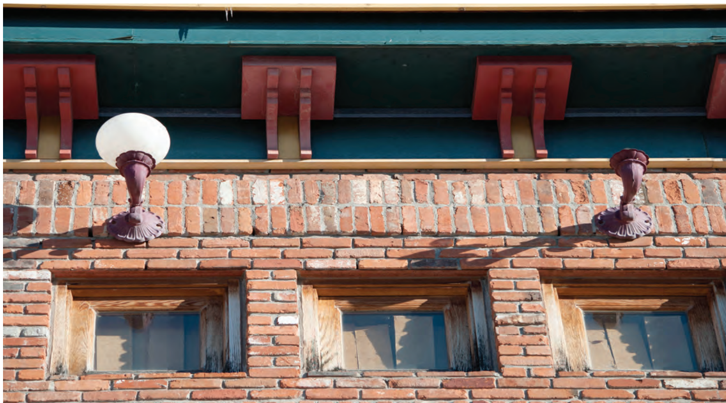
Détails architecturaux et éclairage de la façade Ouest du bâtiment 3.
