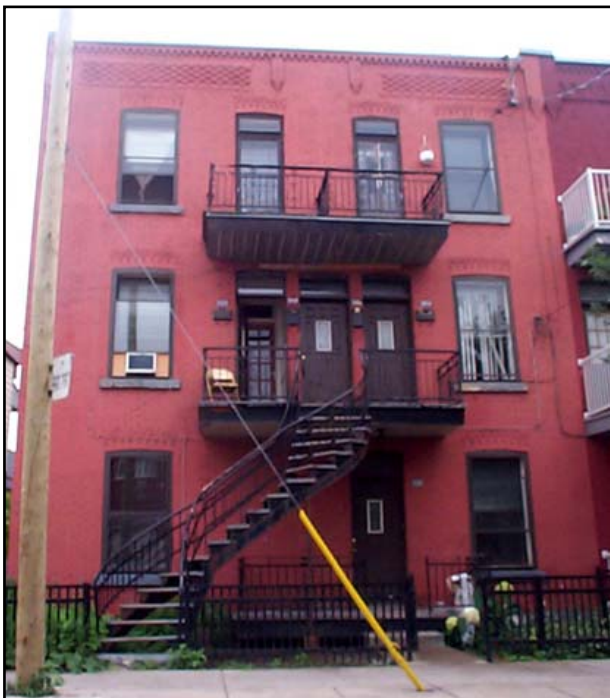
Fig. 2.7.2 : Multiplex situé sur la rue de Rozel, entre les rues Butler et Charlevoix. SO0204.
