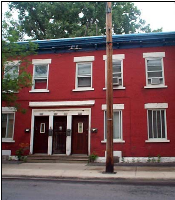
Fig. 2.1.3 : Variante 1 : Duplex avec escalier intérieur de 4 logements dont la composition de la façade possède trois portes jumelées. Il est à noter qu'une seule porte donne accès aux deux logements de l'étage. Situé entre les rues Knox et Ryde. SO0191.
