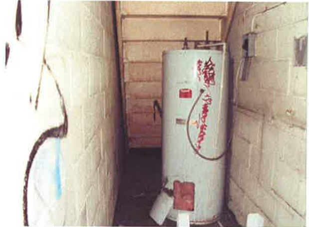
Photo 8 : Vue du chauffe-eau électrique dans l'entrepôt
