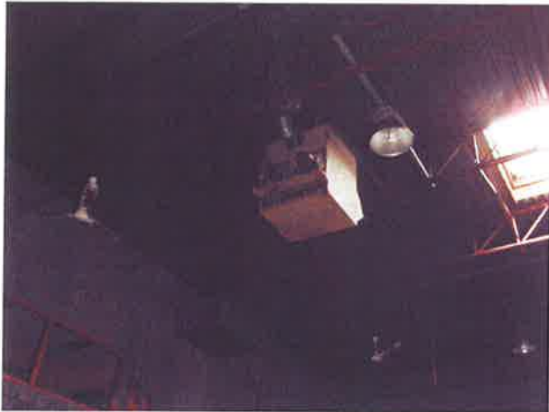
Photo 7 : Vue de l'unité suspendue au gaz naturel dans l'entrepôt.
