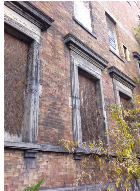
DÉTAIL DES ENCADREMENTS DE PIERRE DE L'ÉTAGE
