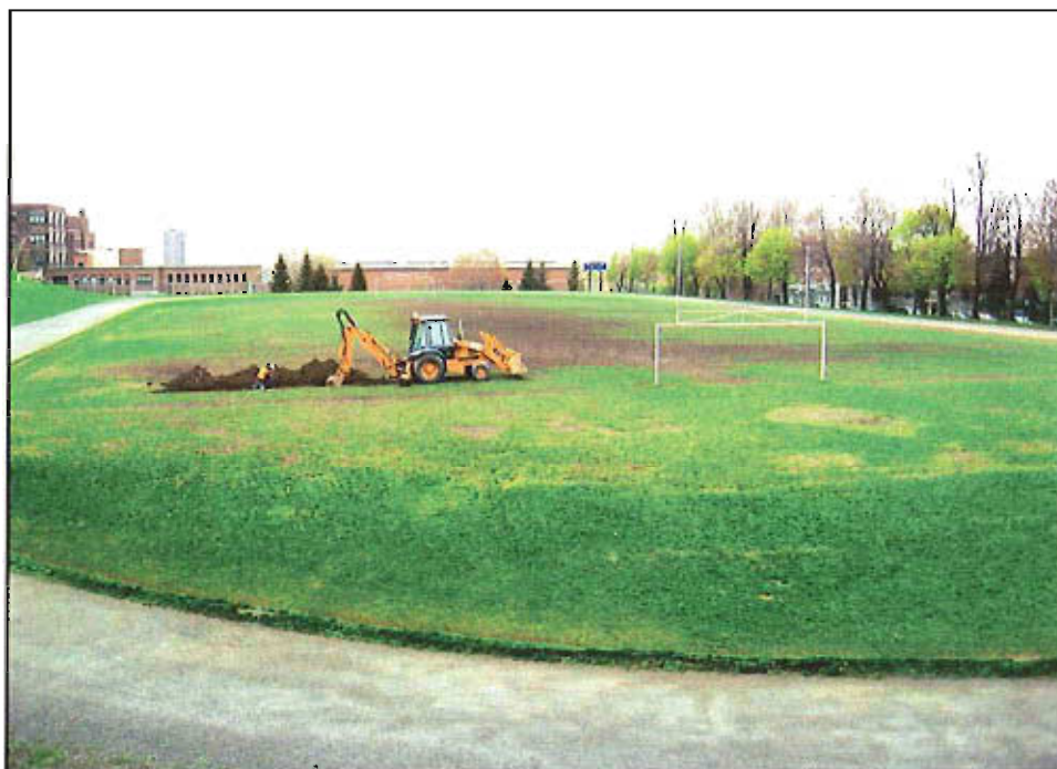
Photo 1 : Vue générale de l'aire d'intervention au moment de l'excavation de la tranchée 1A, vue en direction nord-ouest. (MTL08-09-2-NUM1-2)
