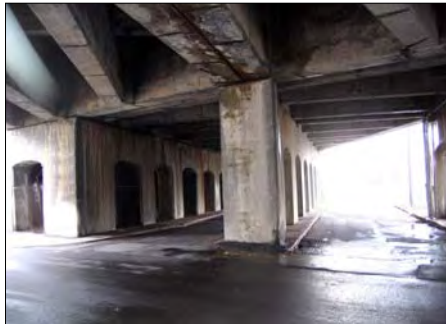
Arcades sous le viaduc ferroviaire, à l'angle des rues Ann et Wellington.
