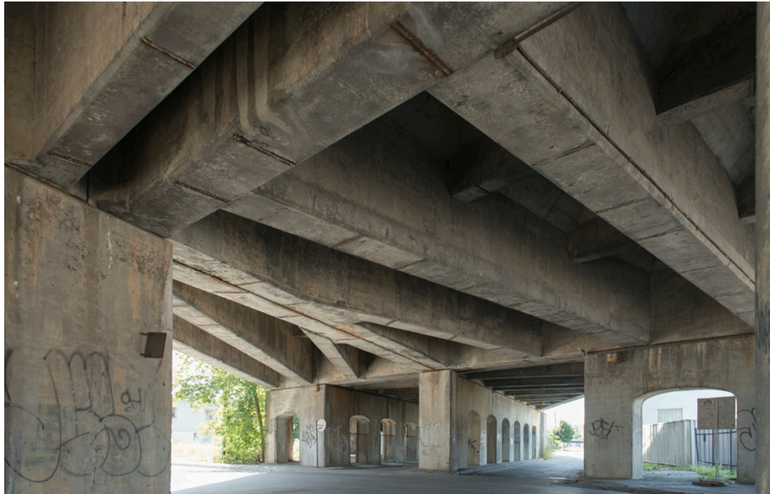
Viaduc du Canadien National, rues Dalhousie, Nazareth, Ottawa, William, Saint-Paul Ouest, Saint-Maurice. VM, 2012
