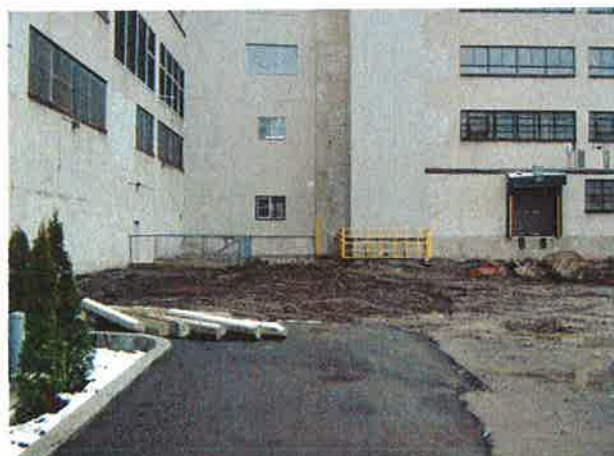
Photo 3 : Fin de la rampe d'accès au 6650 rue Saint Urbain et enlèvement de l'asphalte dans l'excavation principale
