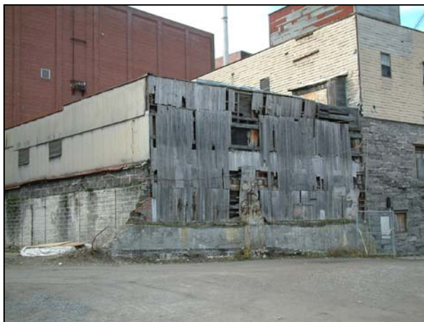
Annexe sud du bâtiment en mauvais état. 2006.
