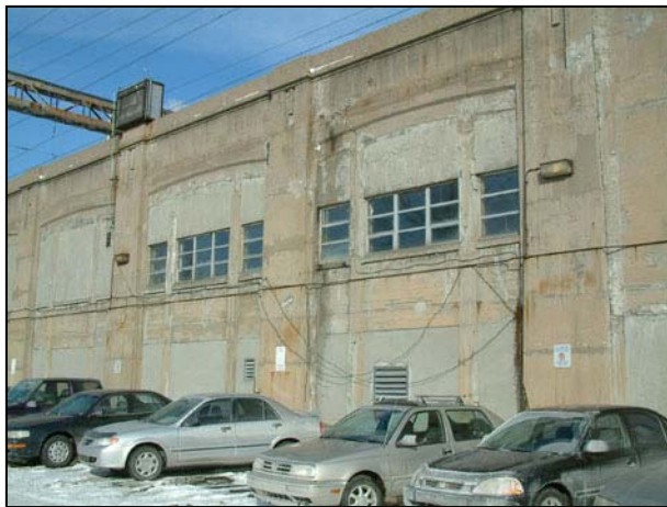
Viaduc du CN. Ouvertures murées et surfaces en mauvais état. 2007.
