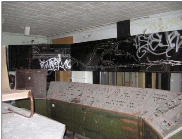
Intérieur du poste de contrôle avec les équipements encore en place. Photo : Stéphane Conant, 2005.
