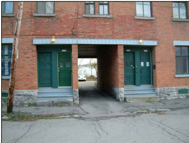
La seule porte cochère de l'ensemble qui donne accès à la cour arrière. Un revêtement de tôle recouvre le linteau de pierre et la porte de gauche est condamnée. 2006.
