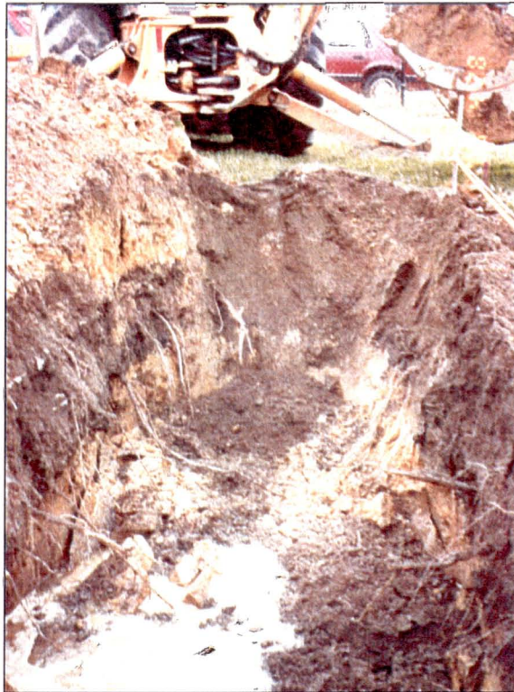
Photo 3 : Vue est du puits d'exploration 02F144-6. On observe une infiltration d'eau abondante entraînant l'affaissement des parois.
