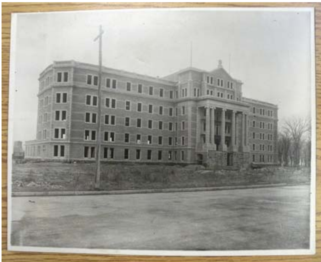
Construction du corps principal, sans date. On aperçoit la petite aile latérale arrière d'un seul étage, du côté sud. (Archives des Clercs de Saint-Viateur)
