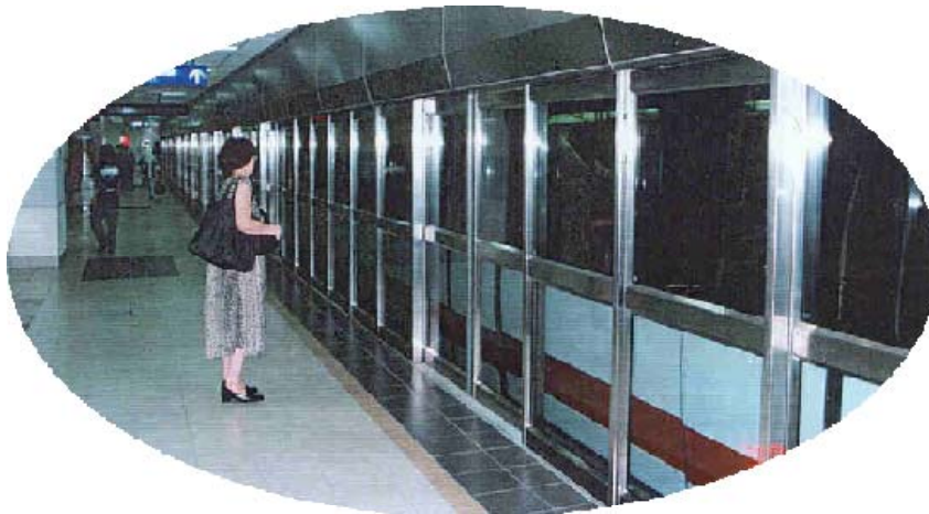
FIGURE 20 - Exemple d'un système de portes palières
