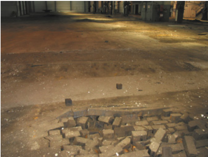
Le revêtement de sol composé de blocs de bois debout est soulevé par endroits.
