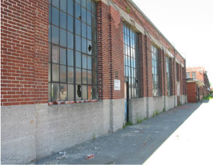
Façade nord de la même section du bâtiment, laissant voir les murs massifs en brique sur une base de béton et les grandes baies industrielles à petits carreaux, dont certains sont cassés.
