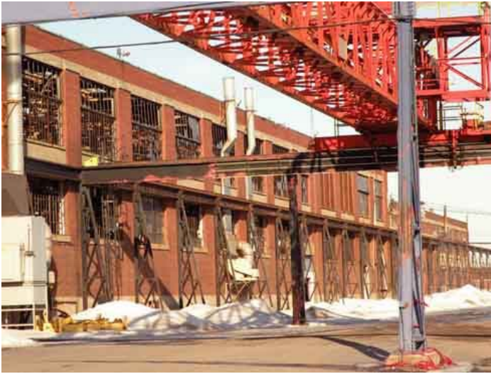
L'extrémité ouest de la façade sud, après l'incendie.
