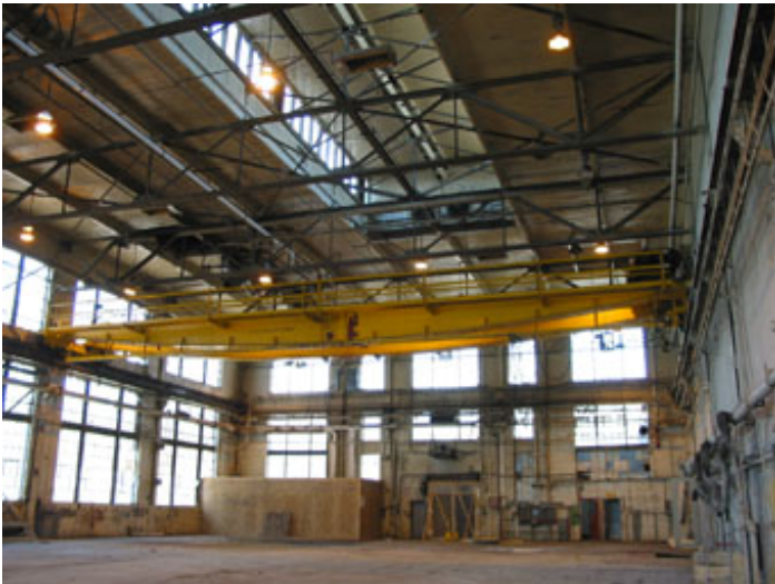
Les puits de lumière ainsi que les ponts roulants sont toujours en place.
