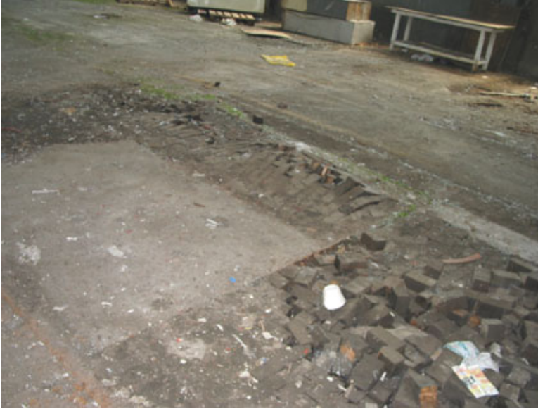
Certaines sections du bâtiment D ont des planchers faits de blocs de bois debout.
