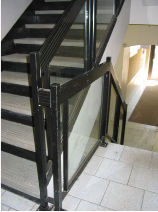
L'escalier central a été complètement refait, mais semble demeuré au même emplacement.
