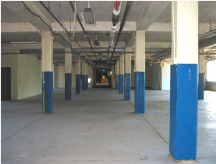
Une autre vue intérieure laissant bien voir la structure de poutres et de piliers en béton.
