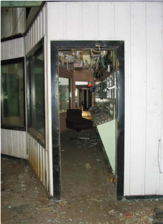
Le poste de contrôle se trouve dans une cabine aménagée à l'intérieur de la centrale thermique.
