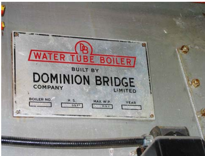
La bouilloire a été remplacée en 1966, tel que l'atteste cette plaque.
