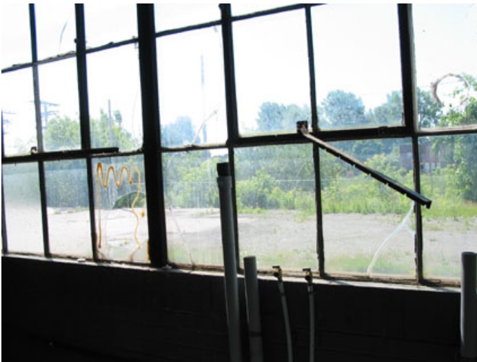
Des fenêtres d'origine, aux multiples petits carreaux de verre montés dans une structure d'acier. Plusieurs carreaux sont brisés et les montants sont généralement rouillés.
