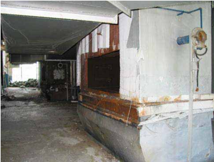
Une des composantes de la bouilloire, à l'intérieur de la centrale thermique.
