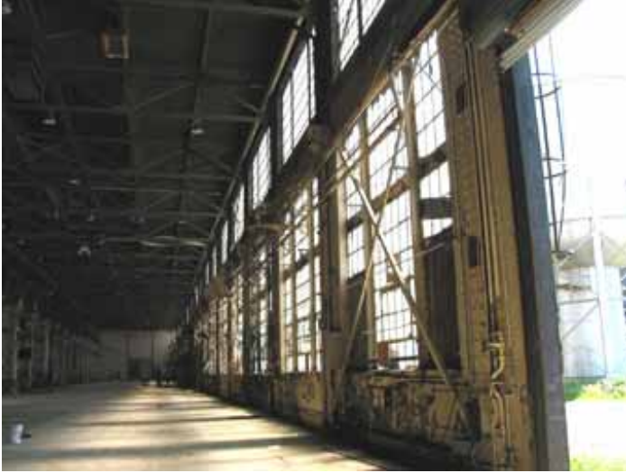
Un abondant fenêtrage sur les façades latérales permet à la lumière naturelle d'envahir l'intérieur de l'atelier.
