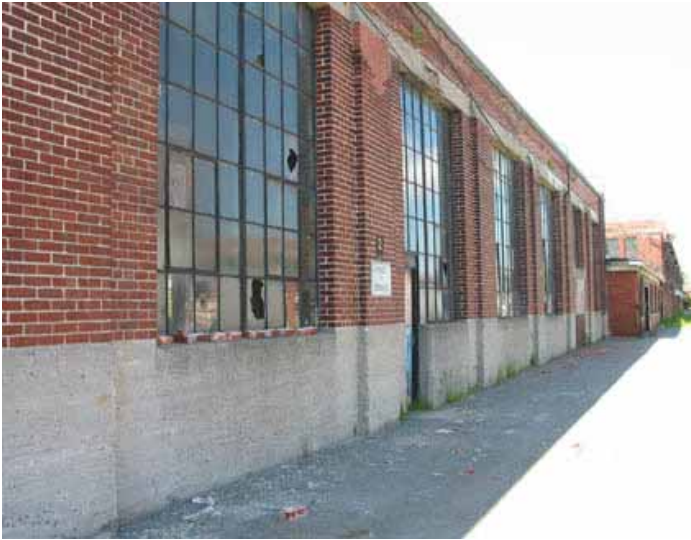
Façade nord de la même section du bâtiment, laissant voir les murs massifs en brique sur une base de béton et les grandes baies industrielles à petits carreaux, dont certains sont cassés.
