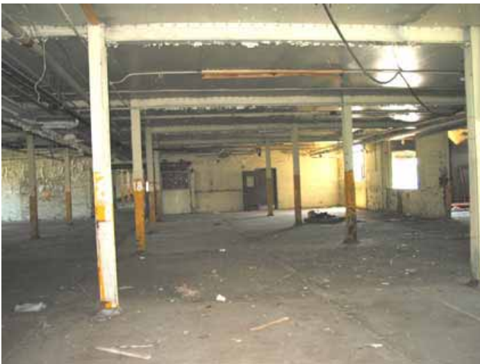
Vue intérieure des sections centrales des magasins, construites en 1924, sur laquelle on peut voir le plafond et le plancher en béton ainsi que la peinture écaillée sur les surfaces.
