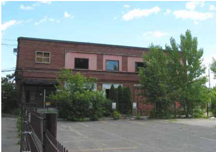
La façade ouest, sur laquelle on distingue que plusieurs ouvertures ont subi des modifications importantes, phénomène également observé en plusieurs autres endroits sur le bâtiment. Un ancien terrain de stationnement se trouve devant cette façade, donnant sur la rue Le Ber.
