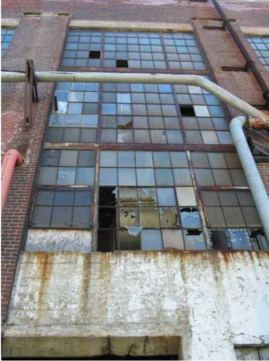
Plusieurs carreaux de verre sont brisés et les taches de rouille sur le béton témoignent de la dégradation des fenêtres en acier.
