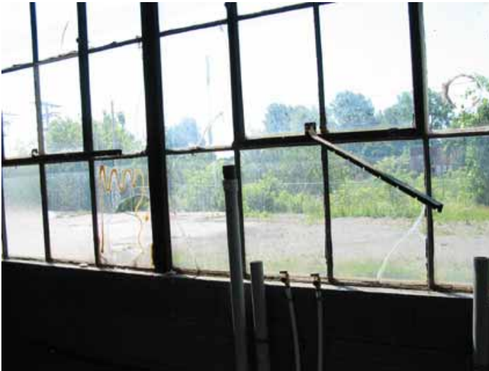
Des fenêtres d'origine, aux multiples petits carreaux de verre montés dans une structure d'acier. Plusieurs carreaux sont brisés et les montants sont généralement rouillés.
