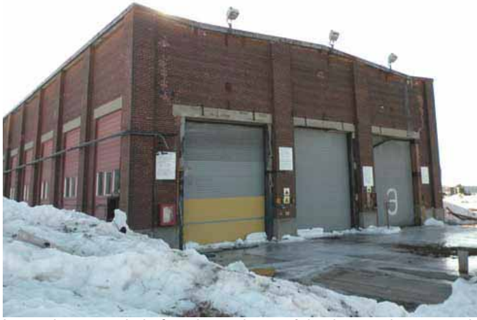
Les trois portes de la façade nord, par où les locomotives pouvaient entrer et sortir du bâtiment.
