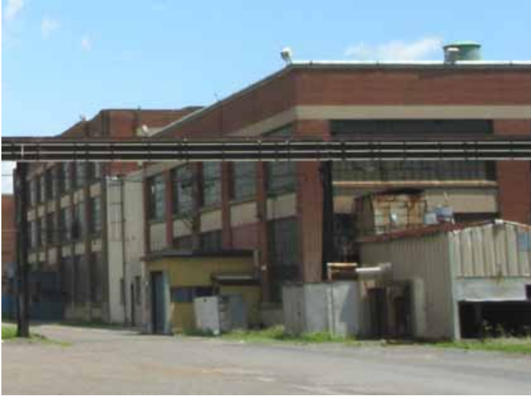
L'angle nord-ouest du bâtiment D laissant voir trois parties de quatre parties, de hauteur légèrement différente : à l'arrière, le « Foundry and Pattern Shop », à l'avant, le « Wheel Shop » et au centre, la partie de béton réunissant les deux précédentes. On aperçoit également de petits appentis métalliques adossés au bâtiment.
