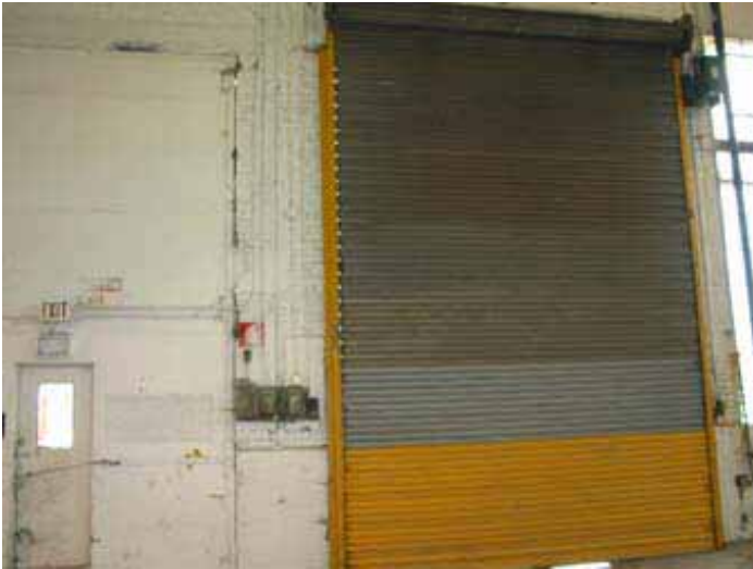
Vue de l'intérieur de la façade ouest de la première partie du bâtiment. Les portes ont été modifiées depuis la construction d'origine.
