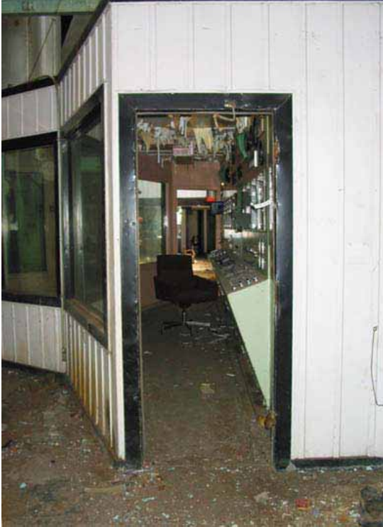
Le poste de contrôle se trouve dans une cabine aménagée à l'intérieur de la centrale thermique.
