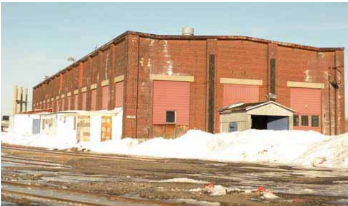
Cette photo de la façade sud, prise en février 2009, permet de constater que l'extrémité est du pont roulant a été démantelée. On aperçoit également les ouvertures murées de la façade latérale nord ainsi qu'une série d'appentis jouxtant la façade, dont la date de construction est inconnue.
