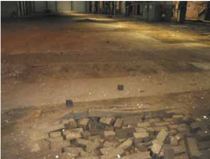
Le revêtement de sol composé de blocs de bois debout est soulevé par endroits.
