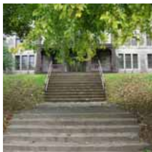
E6 Escaliers en béton coulé, deux volées sur sol (7 et 11 contremarches) intégrés à la topographie du talus. Mains-courantes non-conformes et justes sur la 2e volée. Le béton étant en mauvais état, les escaliers sont à refaire et le traitement mérite d'être intégré à l'ensemble des aménagements.
