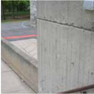
M5 Murets de soutènement multiples en béton coulé qui ceinturent le toit-terrasse et l'escalier rejoignant le parterre. Muret dont l'état est moyen et l'aspect peu intéressant.
