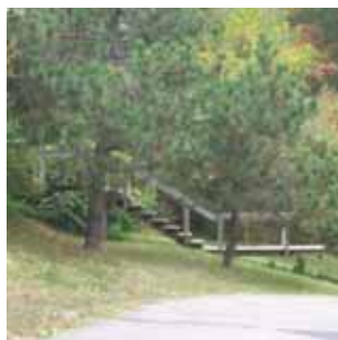
E2 Escalier en bois traité à deux volées. Localisé à l'intérieur du site, il traverse le talus entre les deux voies à l'est du site. Mains courantes non-conformes au CNB. Il est en assez bon état. Il mérite d'être davantage intégré au talus et à l'ensemble des aménagements.
