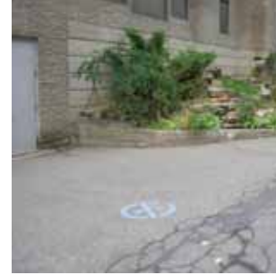
M4 Petit muret de soutènement en béton coulé qui ceinture la plate bande et la rocaille adossée au bâtiment. Muret dont l'état est moyen et l'aspect peu intéressant.
