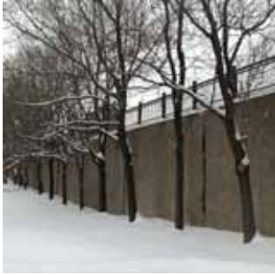
M1 Mur de soutènement en béton coulé longeant une partie du chemin de la Côte-Des-Neiges. Muret en assez bon état et dont la présence contribue au sentiment d'enclavement de l'entrée.
