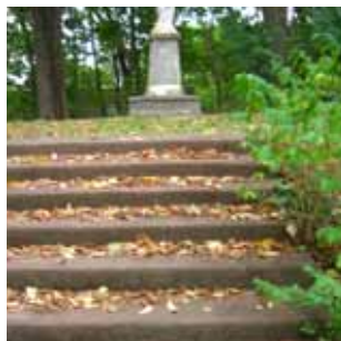
E5 Escalier en béton coulé et peint, conduisant aux statues localisées à l'extrémité ouest du site. La position des marches et leur largeur témoignent des processions passées et dégagent une certaine solennité. Le béton est très altéré et l'escalier est à refaire en entier. Il mérite d'être intégré à l'ensemble des aménagements.
