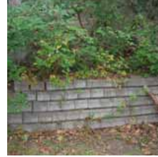
M7 Petit muret en blocs de béton préfabriqué soutenant le sol sur le côté de la façade ouest du bâtiment arrière. Muret dont l'état est moyen, qui est délabré et dont le matériau est peu intéressant.
