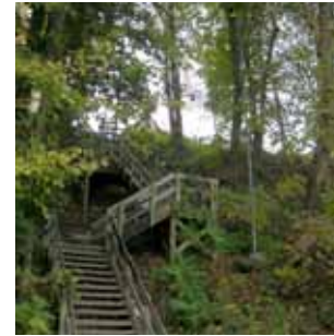
L7 Appareil d'éclairage sur fût situé à mi-course de l'escalier rejoignant le chemin de la Côte-des-Neiges. De condition moyenne, il doit être relocalisé ou enlevé.
