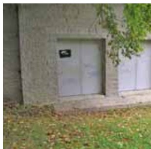
P17 Perron avec contremarche qui donne accès aux locaux techniques. Il n'y a pas d'accès universels et le béton est en mauvais état. Le perron doit être refait.
