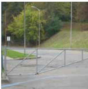
C5 Barrière composée de tubulaires en acier galvanisé, située près de l'entrée ouest du site et à côté des tennis. Elle ferme l'accès à la voirie. Elle est en état moyen avec un peu de rouille. C'est un élément fonctionnel, mais pas intéressant.
