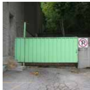
C4 Barrière opaque en acier peint pour la zone de livraison. 1.7m de haut. Elle est en bon état, mais peu intégrée à l'environnement et de faible intérêt visuel.
