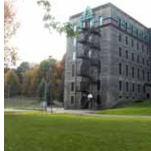
P9 Porte en partie dissimulée par l'escalier d'issue, ancré sur une dalle de béton. Elle ne possède pas d'accès universel.
