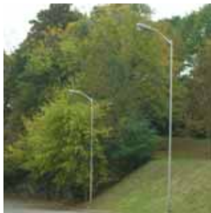
L2 Éclairage du stationnement et de l'entrée depuis Westmount. Fût en acier hauteur +/- 8.0m. Bon état. Photométrie à vérifier. Les appareils ne sont pas récents. En général utilisés dans les rues plutôt que sur des terrains privés.
