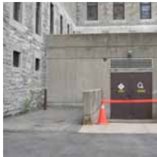
M5A Murets de soutènement pour la rampe menant à la salle électrique. Murets en bon état, mais qui sont peu intéressants visuellement.
