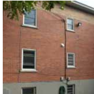
L10 Projecteur carré fixé à la hauteur du 2e étage sur le mur extérieur du bâtiment. Il joue un rôle de sécurité. Il y a plusieurs filages électriques apparents. À remplacer.
