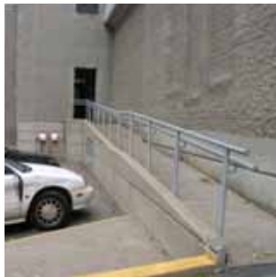
P15B Rampe d'accès du gymnase. Elle est en béton coulé avec mains-courantes en acier galvanisé. Il y a de la ventilation sous la rampe. Elle est en bon état mais pas conforme aux normes d'accessibilité universelle et peu intégrée au contexte.
