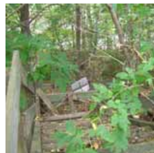
E8 Ancien escalier en bois reliant l'avenue Cedar à l'entrée est du bâtiment. Il ne reste que quelques marches et des poteaux éparpillés. Un escalier de bois plus récent le remplace plus à l'est. Les restes devraient être enlevés et la zone revégétalisée.
