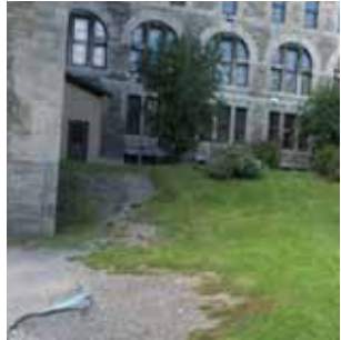
P8 Sentier vers la porte d'accès au petit cabanon rajouté en façade avant du Séminaire. À noter l'érosion et la dégradation importante du revêtement asphaltique. Gazon abîmé à refaire.
