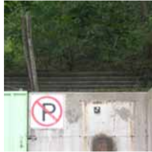
M3 Mur de soutènement en béton coulé qui sert de fermeture à l'enclos de services. Muret dont l'état est moyen et l'aspect peu intéressant. Un second muret en blocs de béton « unitalus » en arrière-plan retient une partie du talus.
