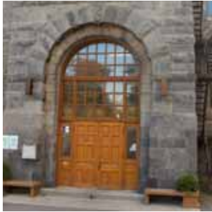
P1 Accès principal, façade Côte-des-Neiges, composé d'une dalle de béton sur sol et d'un perron en béton coulé. En bon état, mais ne répond pas aux normes d'accessibilité universelle. Le traitement pourrait être plus raffiné pour exprimer le seuil de cette entrée principale.
