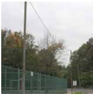
L1A Poteaux électriques (fûts métalliques) pour l'alimentation de diverses lumières. À relocaliser selon les besoins futurs, pas de valeurs particulières. État moyen.
