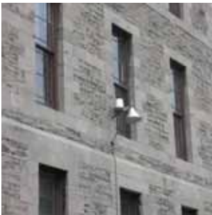
L5B Applique murale ronde située sur la façade arrière du bâtiment principal avec filage en surface. Aucune qualité esthétique ni intégration.
