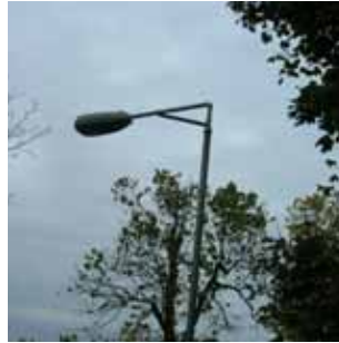
L6 Appareil d'éclairage sur fût situé près de l'escalier rejoignant la Côte-des-Neiges. En condition moyenne, il doit être relocalisé ou enlevé.
