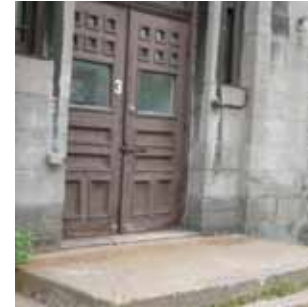
P5 Perron avec une contremarche; issue sud-est du Séminaire. Il n'y a pas d'accès universel, le béton est en mauvais état. Le perron doit être refait.
