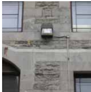
L5A Applique murale carrée sur le bâtiment principal avec filage en surface. Aucune qualité esthétique ni intégration.
