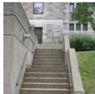
E7 Escalier en béton avec muret en béton servant de garde-corps. Cet escalier permet de rejoindre l'entrée latérale est de la façade principale du bâtiment. L'escalier est peu intégré à l'architecture du bâtiment. Il est en bonne condition générale, mais l'intérêt architectural peu élevé.
