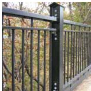
C6 Clôture faisant aussi office de garde-fou pour les véhicules circulant sur le chemin de la Côte-des-Neiges. En acier peint noir, elle est fixée sur un muret de béton. Elle est en excellent état.
