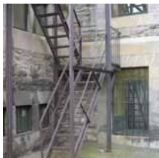
P14 Escalier de secours situé au nord-est du Séminaire. Il est en acier peint et en mauvais état. Il a un faible intérêt visuel et doit être restauré ou remplacé selon les besoins.
