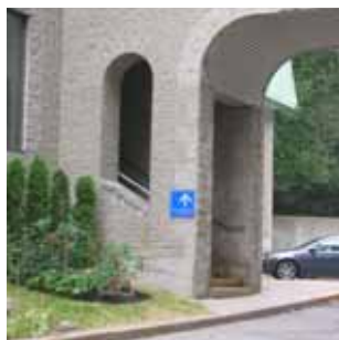
P15A Escalier couvert, entrée principale du gymnase. Il est en béton coulé avec mains-courantes en acier galvanisé. Il est en assez bon état, mais de valeur peu significative.
