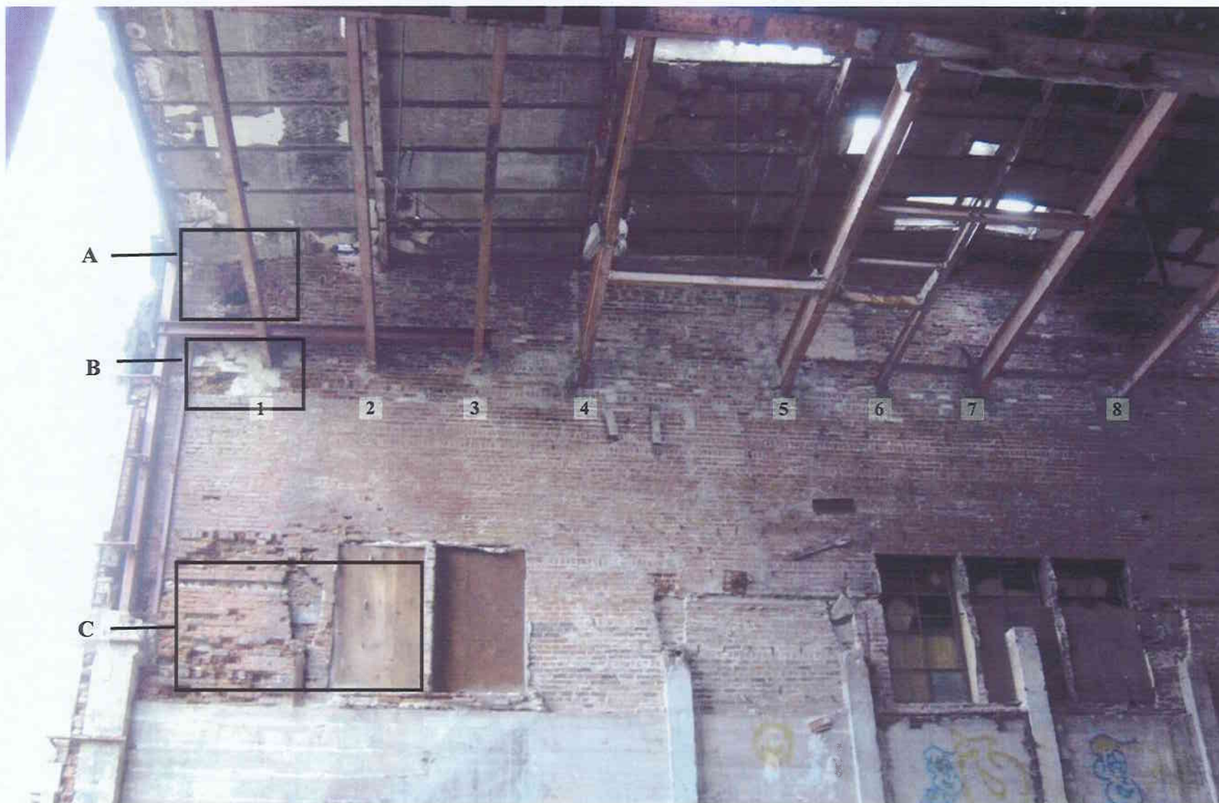
Photo No. 10 – Portion gauche de la façade, avec numérotation des poutres pour références ultérieures.
