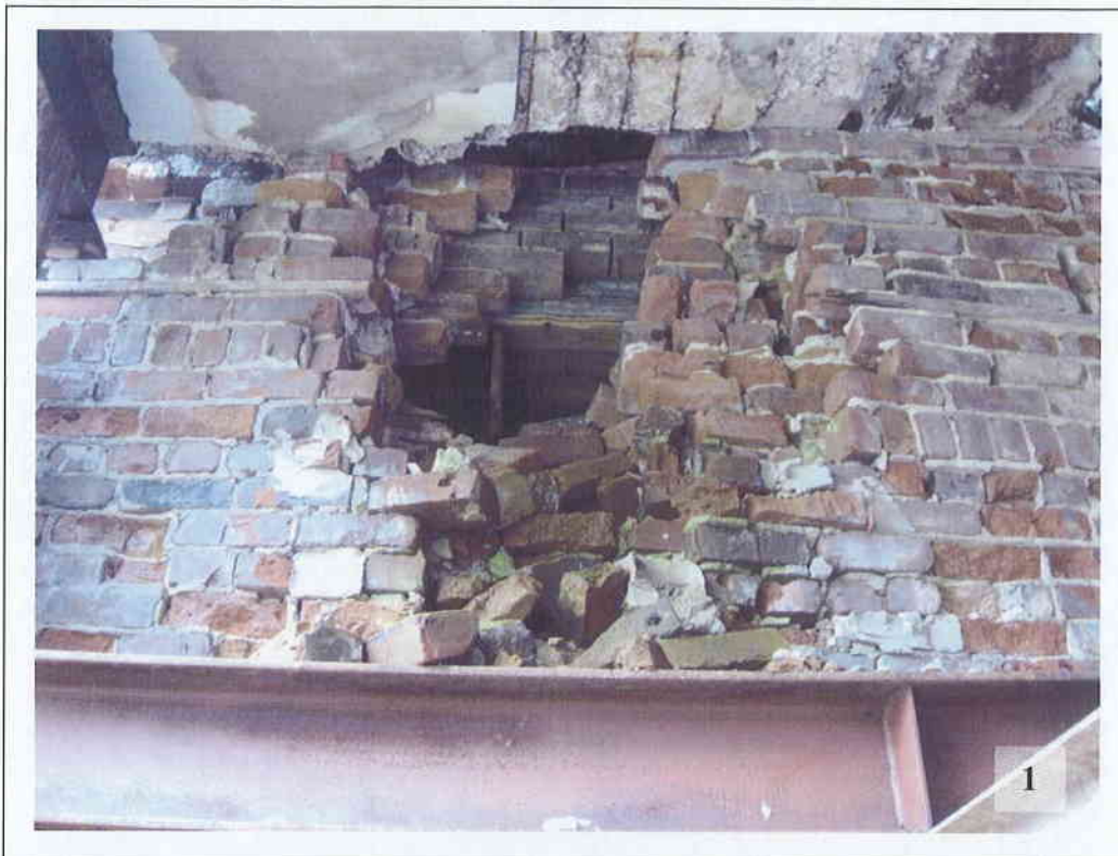
Photo No. 11 – Zoom sur la zone A : effondrement d'une partie du mur porteur, au-dessus de la poutre No. 1.
