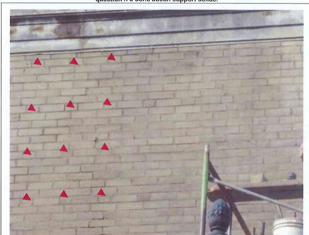
Photo No. 18 – Zoom sur le parement : les briques marquées en rouge sont des exemples de briques placées en boutisse.
