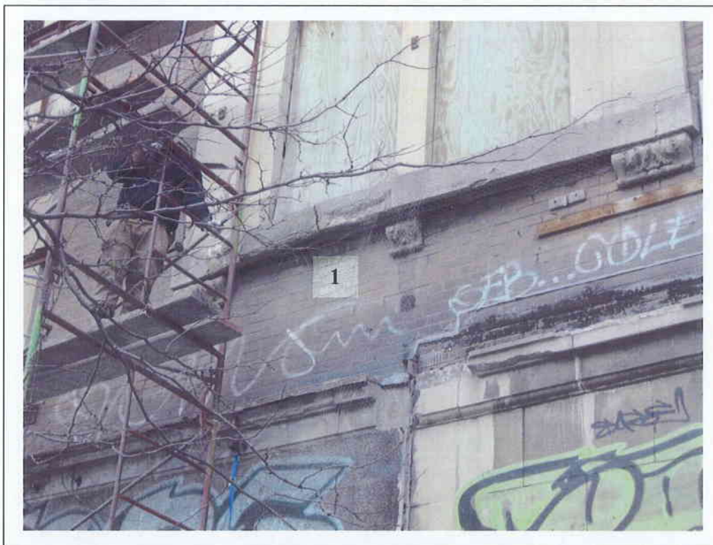
Photo No. 4 – Condition initiale de la fenêtre No. 1 : des morceaux d'allège de fenêtre menaçaient de tomber.
