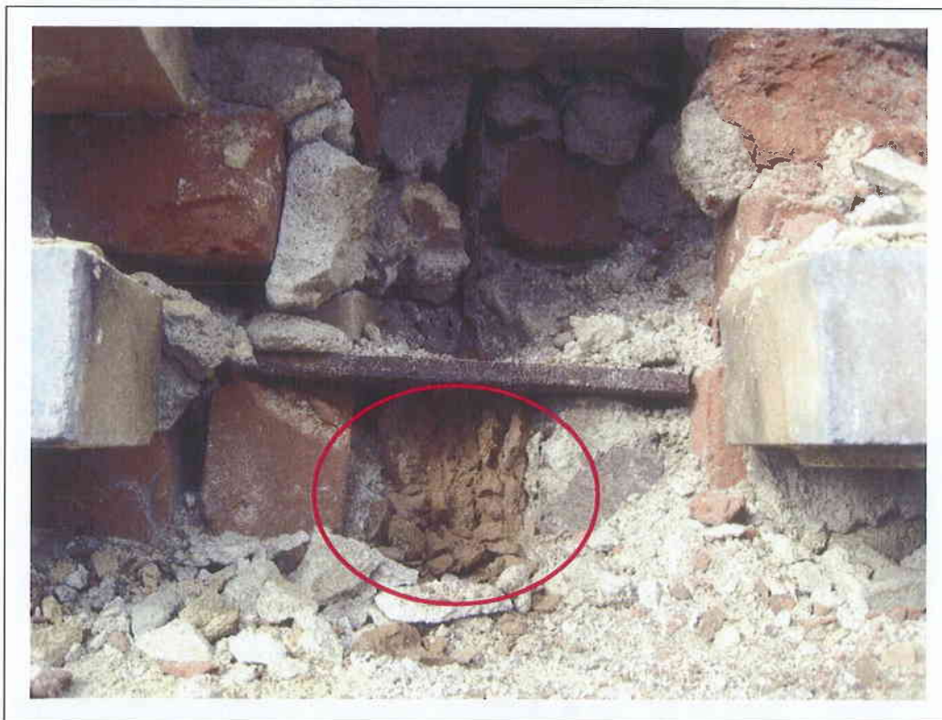
Photo No. 17 – Zoom sur la brique en-dessous de la poutre, complètement effritée. La poutre en question n'a donc aucun support solide.
