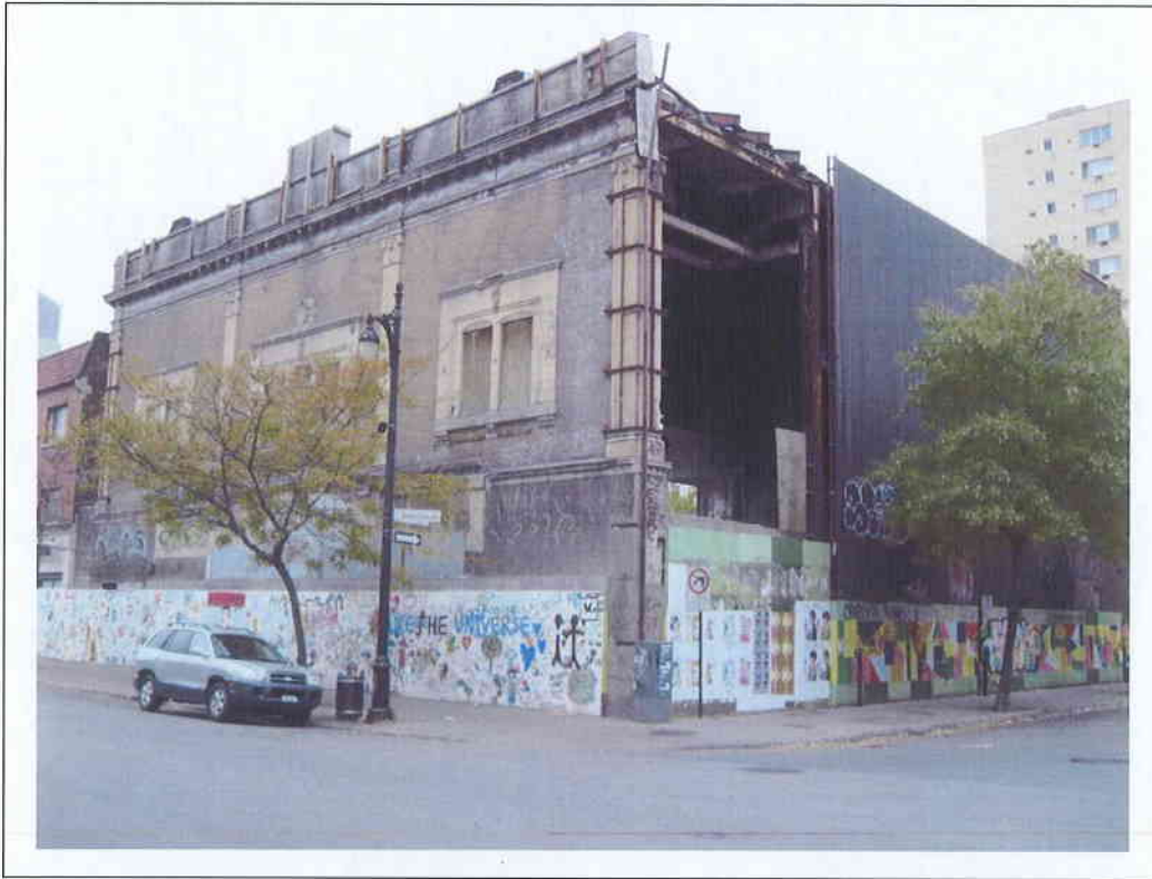
Photo No 1 – Vue générale du bâtiment, depuis l'intersection des rues Ste-Catherine et Chomedey (façades sud et est).
