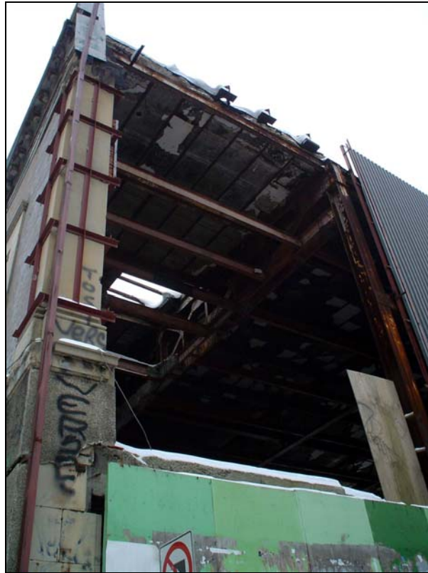
FIG 32 : La façade latérale est de l'édifice est complètement écroulée (C. Boucher, 2007)
