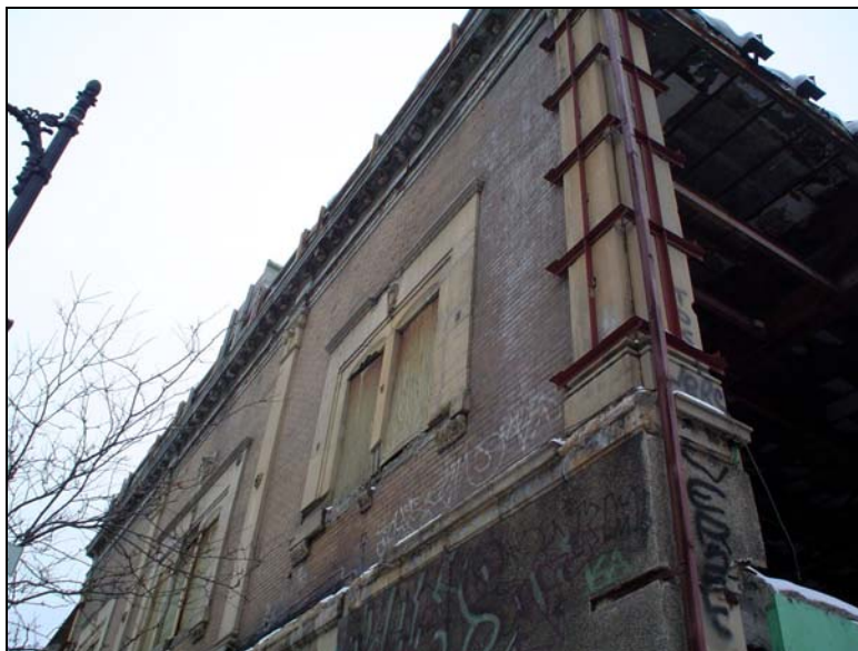
FIG 33 : État physique de la façade de l'ancien théâtre Séville (C. Boucher, 2007)
