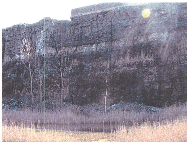
Photo 14 : Section 2, présence de talus d'accumulation de débris à la base de la paroi
