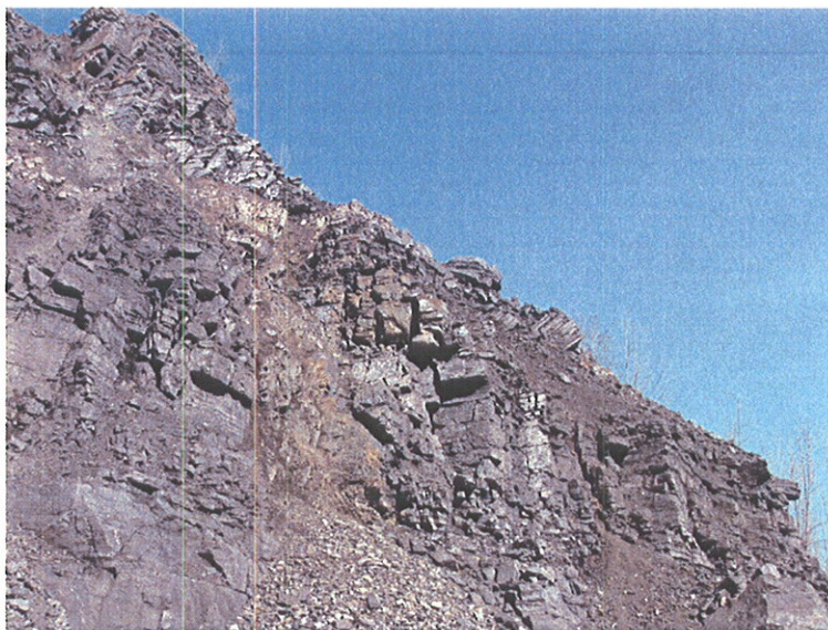
Photo 23 : Section 5, zone de blocs instables
