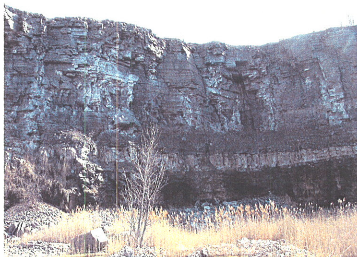
Photo 13 : Sections 1-2, venue d'eau et talus d'effondrement
