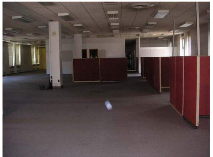
État actuel de l'intérieur de l'annexe à l'étage. La structure et les murs comportent des matériaux d'isolation composites comprenant de l'amiante
