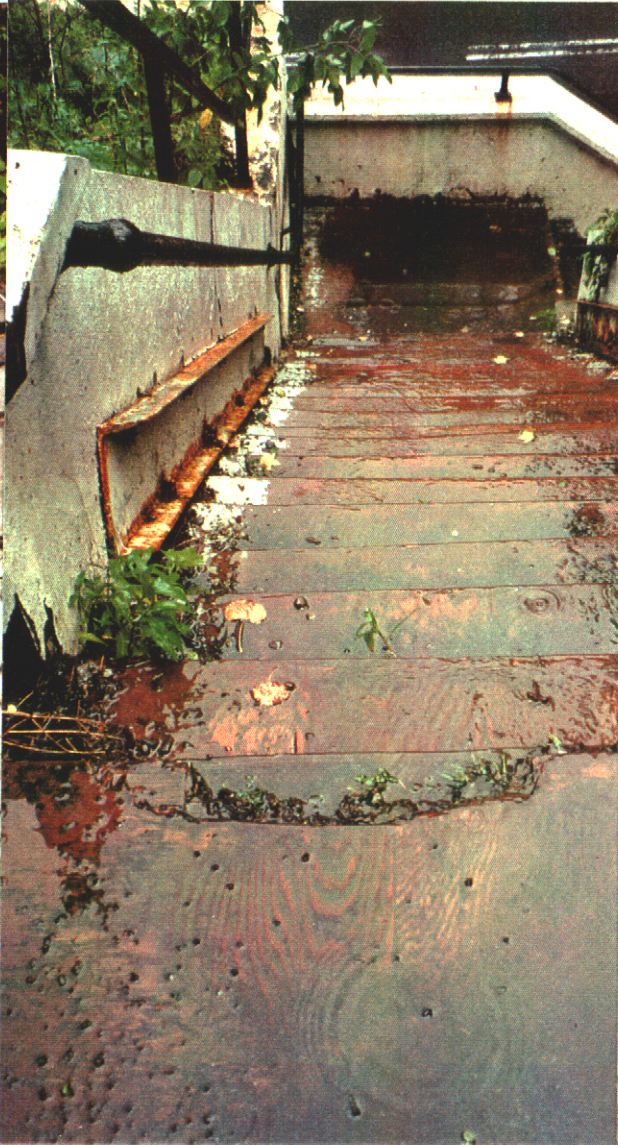
Problèmes: mauvais drainage des eaux de surface, fissuration du mur de soutènement.
