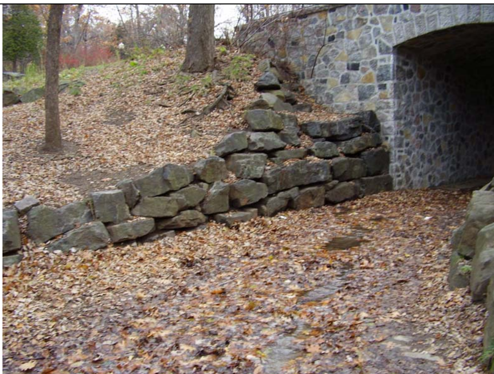
Écoulement non désiré de l'eau provenant du milieu humide
