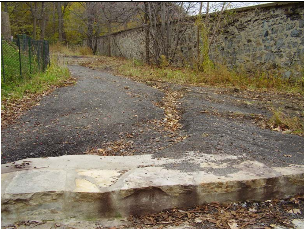
Ravinement avant la section de l'escalier
