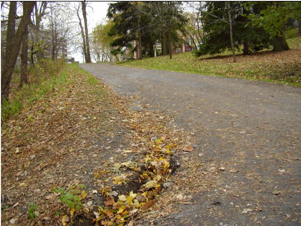
Ravinement longeant le chemin Serpentin et transversal
