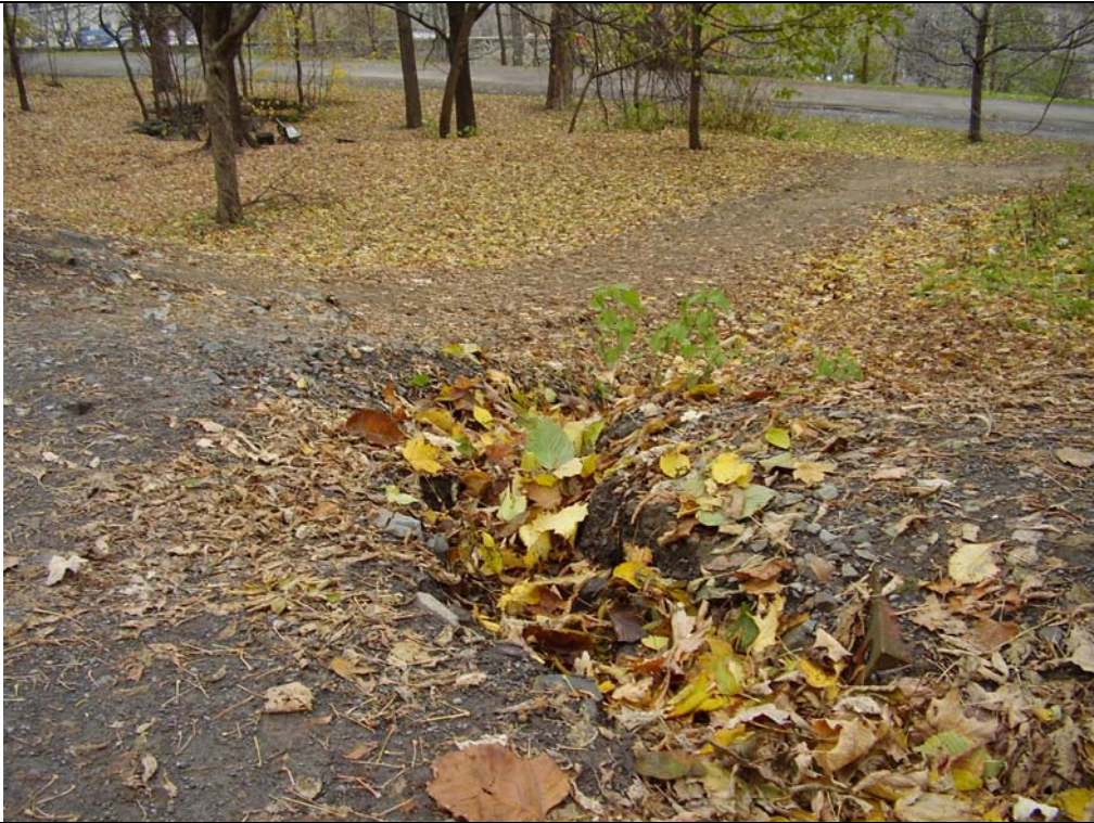
Première partie du chemin transversal entre le premier et le deuxième tronçon du chemin Serpentin : Surface en érosion et en ravinement
