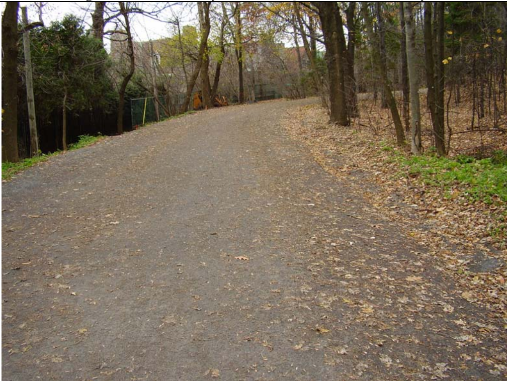
Fin du cinquième tronçon du chemin Serpentin avec le caniveau qui subit du ravinement
