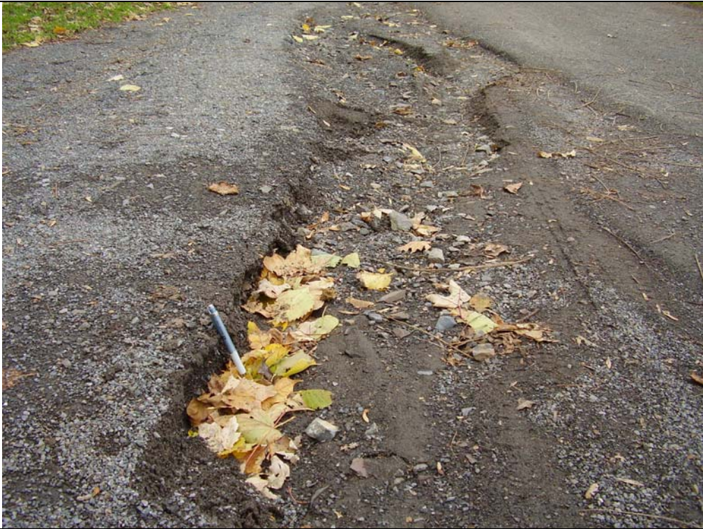
Illustration de l'ampleur du ravinement du premier secteur
