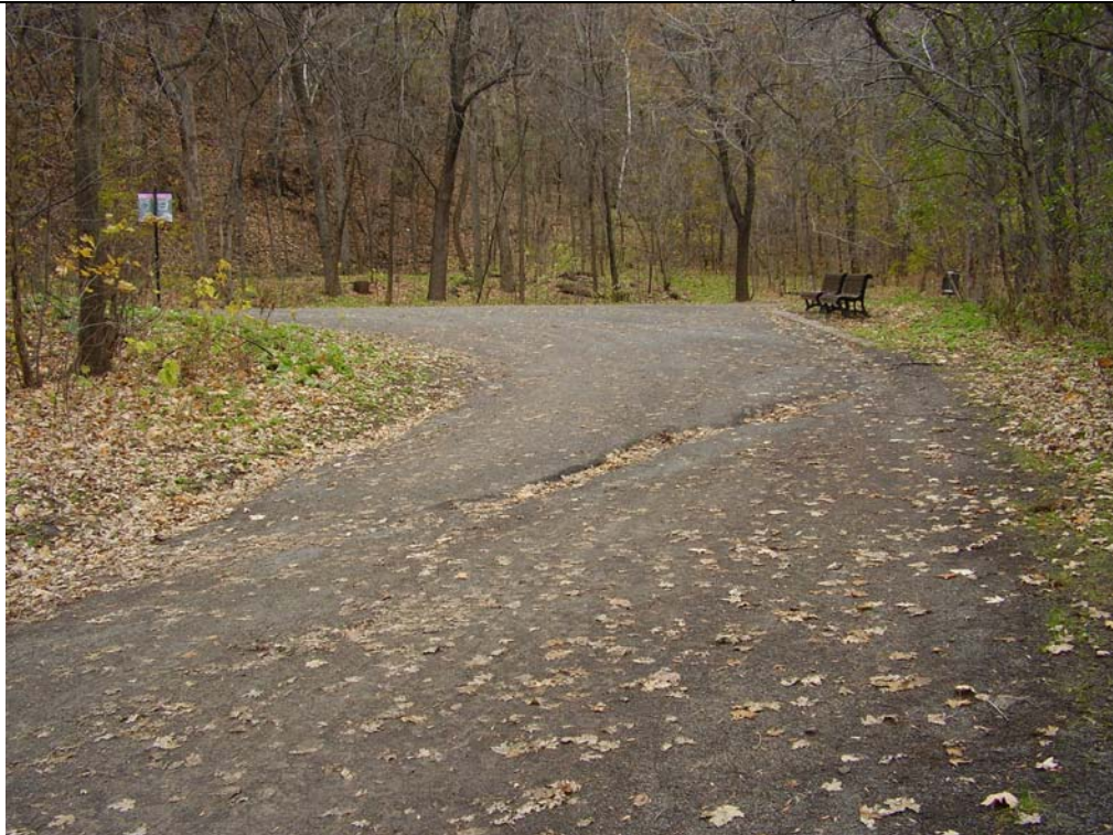
Ravinement sur le chemin Olmsted
