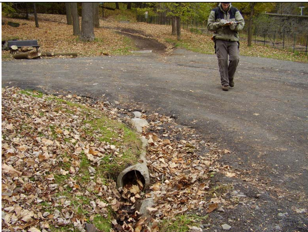
Tuyau de béton qui évacue les eaux du deuxième secteur du chemin Serpentin
