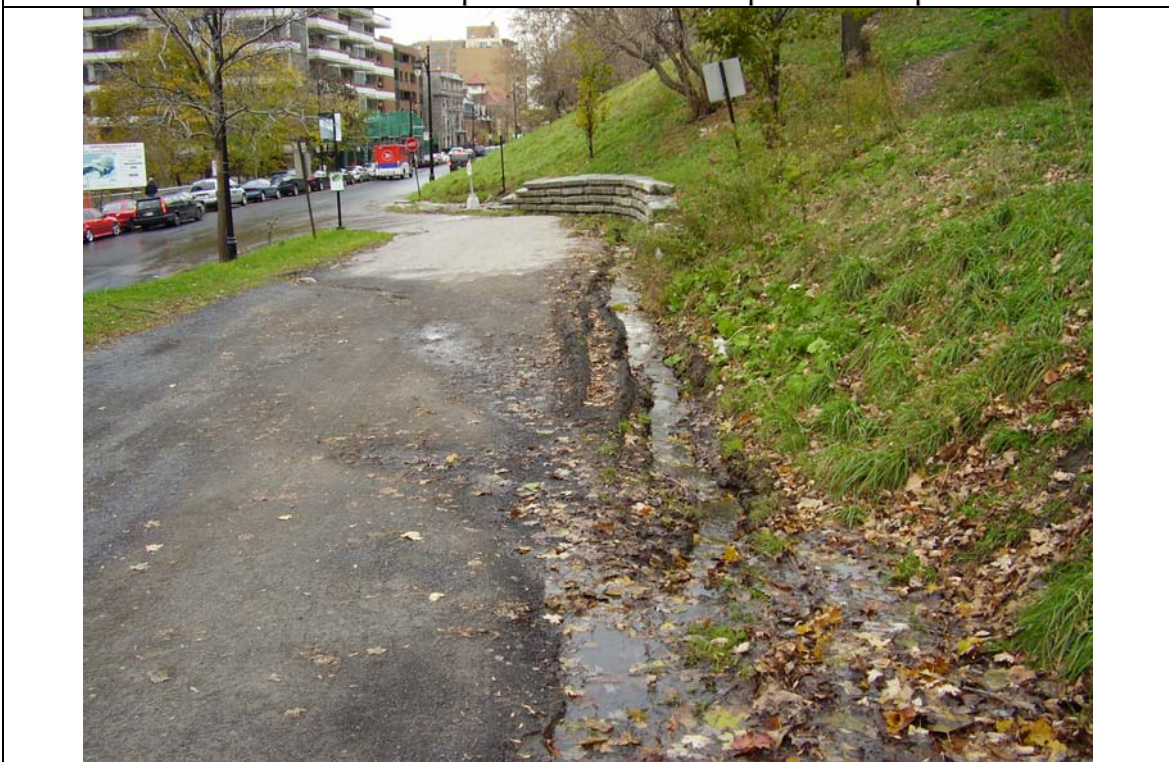
Caniveau en terre avec accumulation d'eau d'une résurgence
