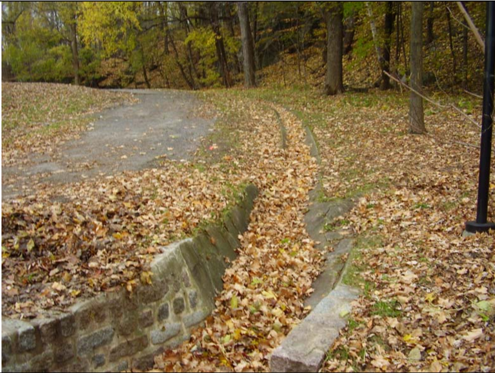
Caniveau de béton et bassin de sédimentation longeant le quatrième tronçon du chemin Serpentin
