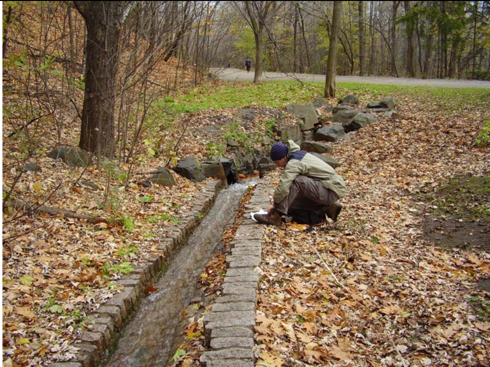
Caniveau en brique et début de la canalisation souterraine situé derrière l'abreuvoir
