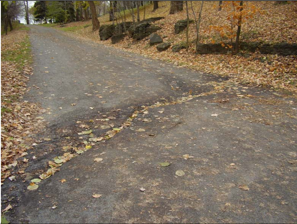
Ravinement par débordement du caniveau dû à l'accumulation de poussière de roche
