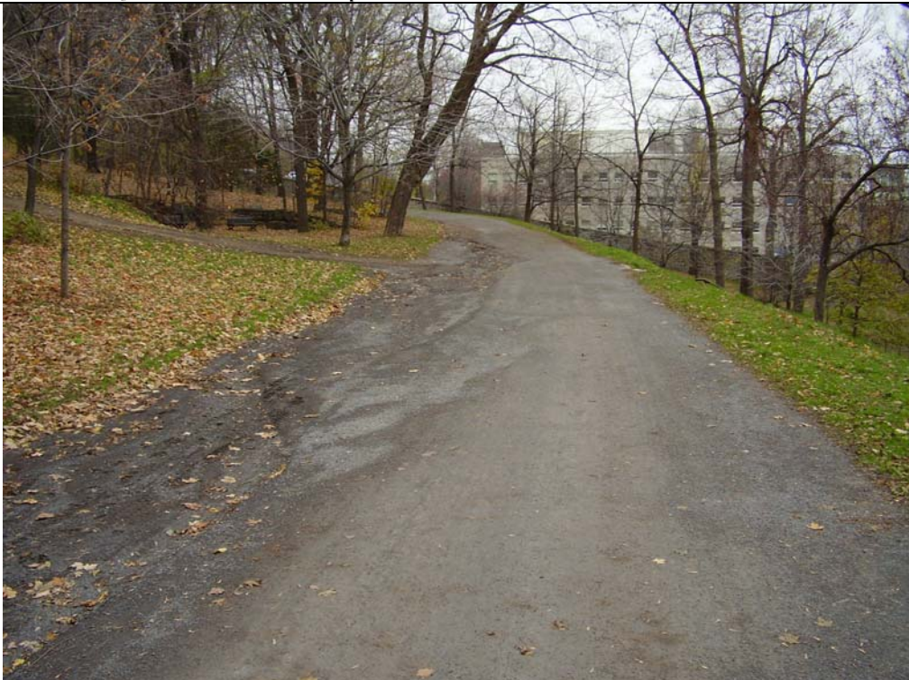
Ravinement du premier secteur du chemin Serpentin en aval du chemin transversal
