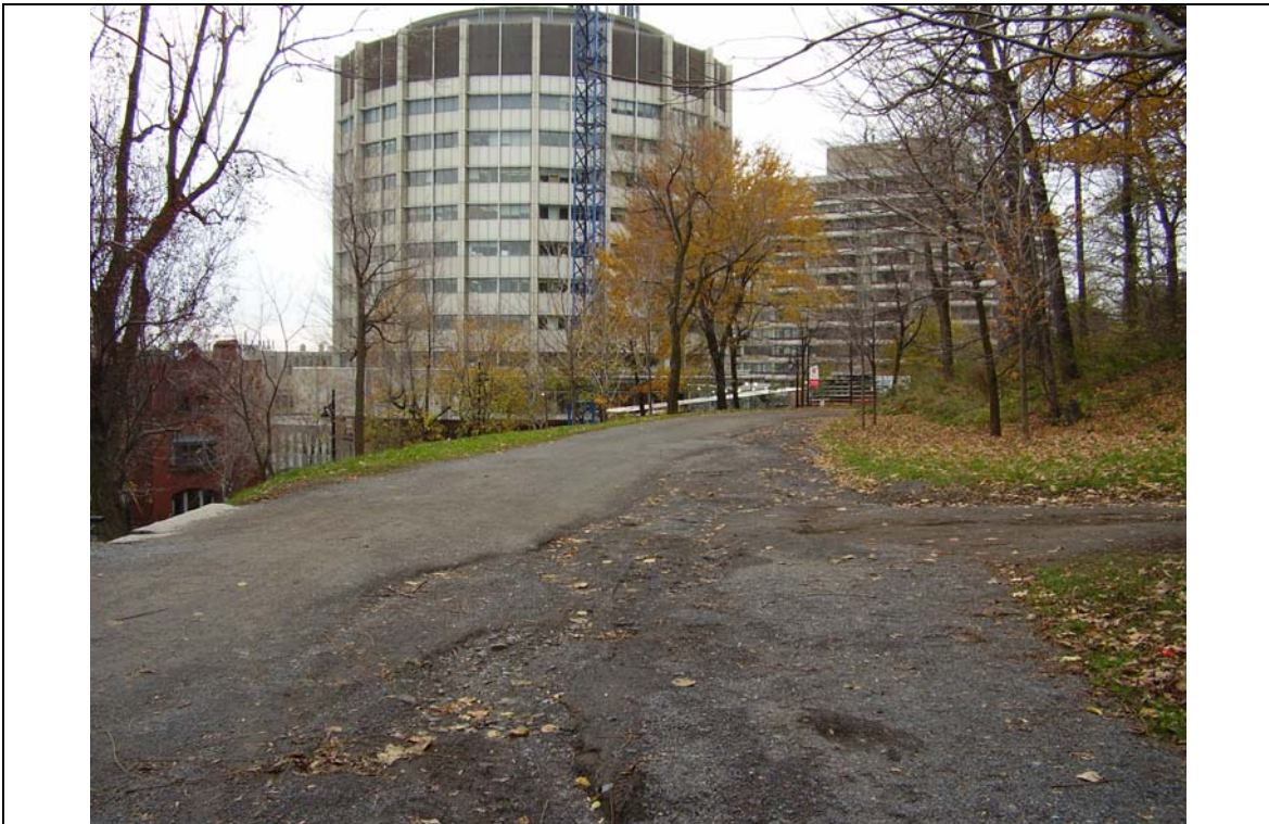
Ravinement du premier secteur du chemin Serpentin en amont du chemin transversal
