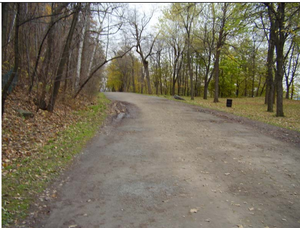
Chemin Olmsted sans structure de contrôle des eaux
