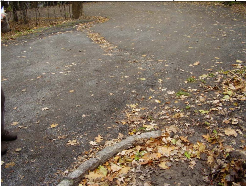
Ravinement provoqué par le comblement du regard
