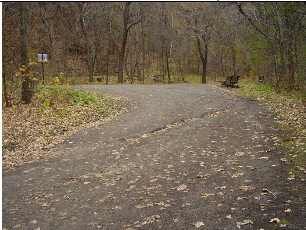
Ravinement sur le chemin Olmsted
