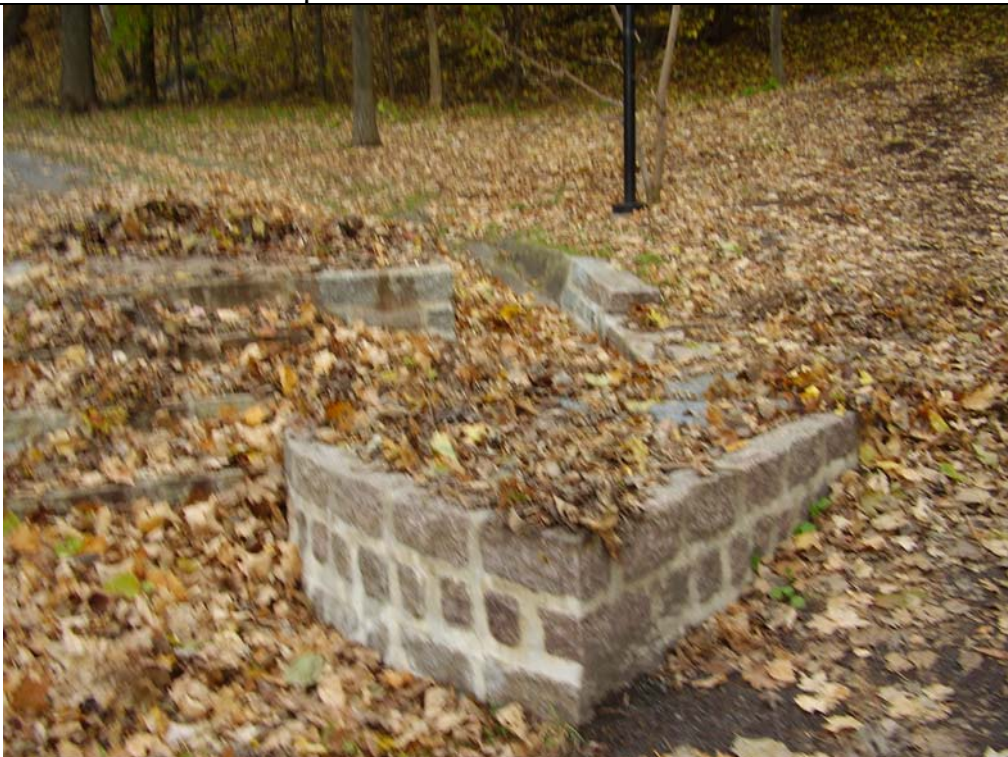
Bassin de sédimentation récoltant les eaux du quatrième tronçon du chemin Serpentin
