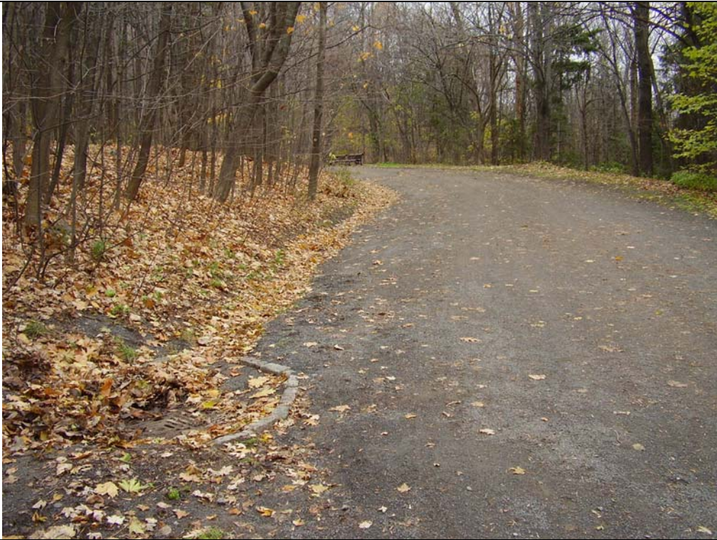
Caniveau et ravinement du sixième tronçon
