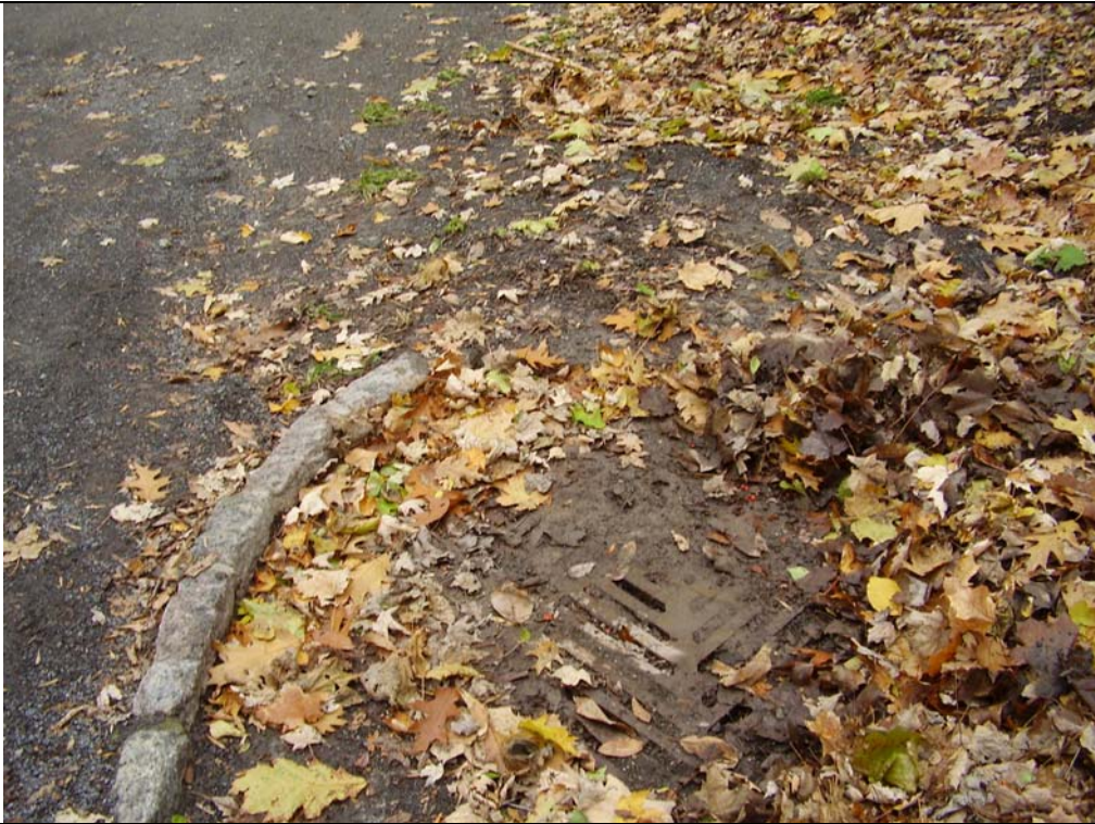
Regard comblé de sédiment au début du sixième tronçon du chemin Serpentin
