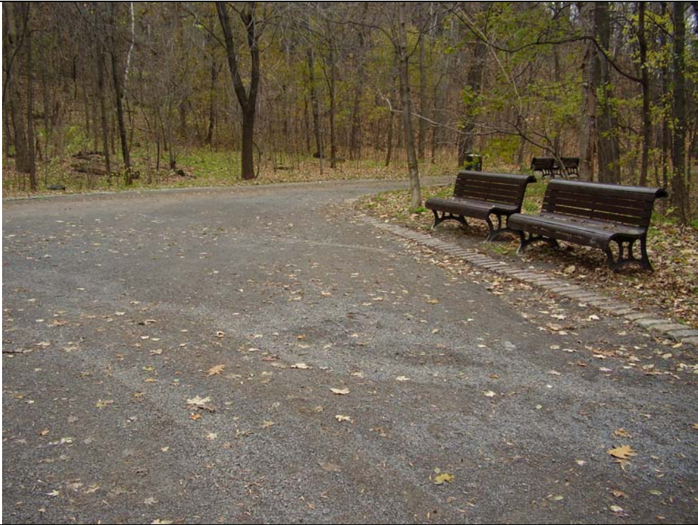
Ravinement provoqué par l'écoulement du chemin Olmsted
