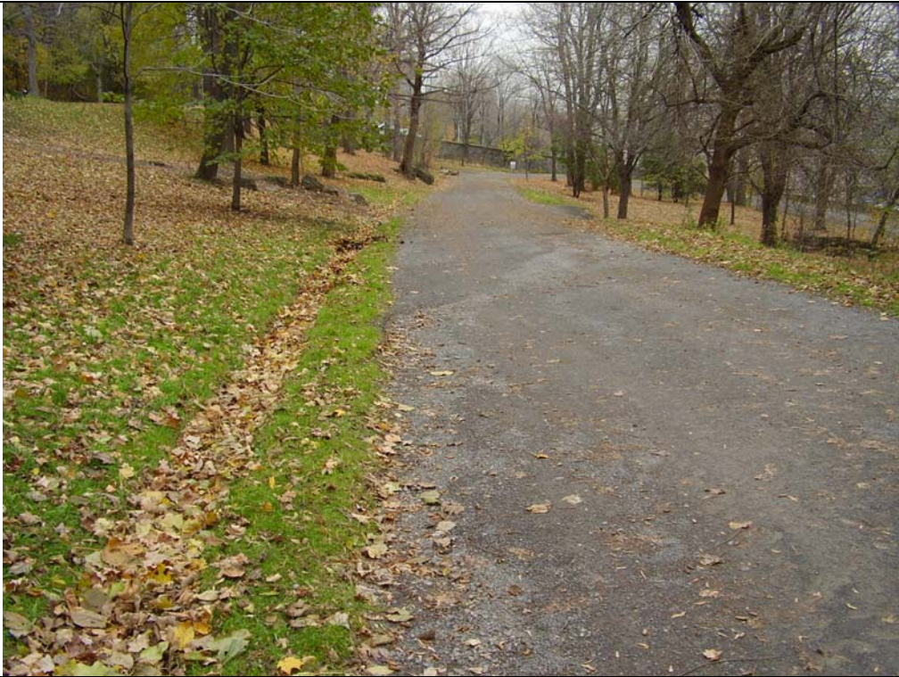
Caniveau de béton et le ravinement dans le deuxième secteur du chemin Serpentin
