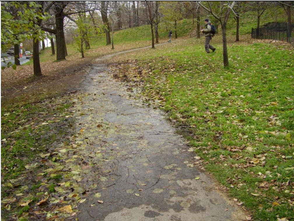
Résurgence de l'eau infiltrée sur le chemin McTavish
