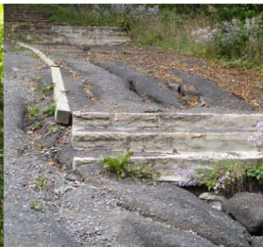
ÉROSION MAJEURE DES ESCALIERS
