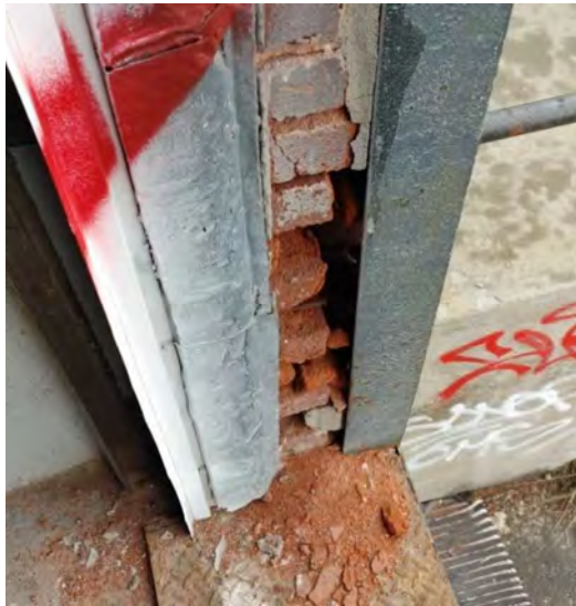
Figure 7. Maçonnerie endommagée par endroit
