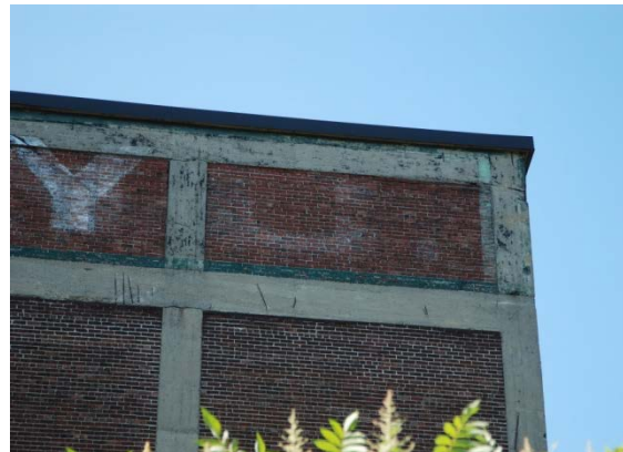
Armature apparente au dernier niveau, juin 2012.
