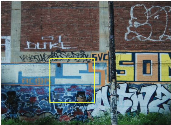
Porte de quai obturée de la façade nord. En liséré jaune, un exemple, mai 2012.
