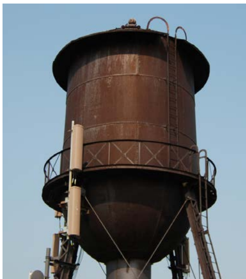
Château d'eau affecté par la rouille, mai 2012. Il a été depuis peinturé.
