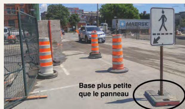
MAUVAIS EXEMPLE DE BASE DE PANNEAU
