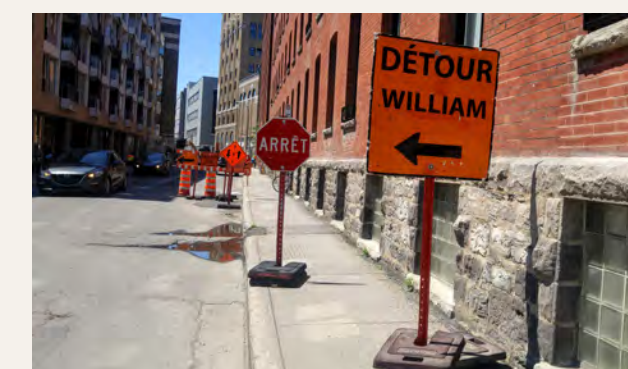
MAUVAISE GESTION DE PASSAGE DE CHANTIER
