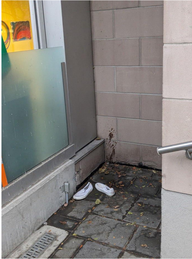
Excréments dans la descente d'escaliers à côté de la cour des enfants
