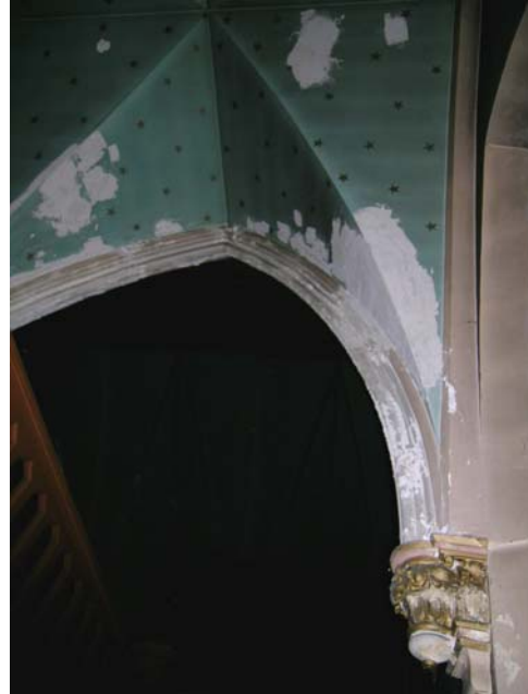
Plâtre défectueux dans la nef (2004).
