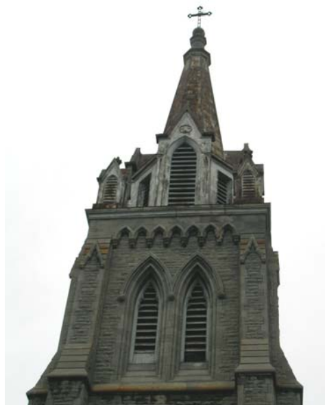
La flèche recouverte de tôle en acier galvanisé montre des signes de rouille (2004).
