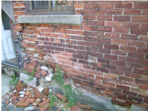
Mur de briques abîmé (2004).
