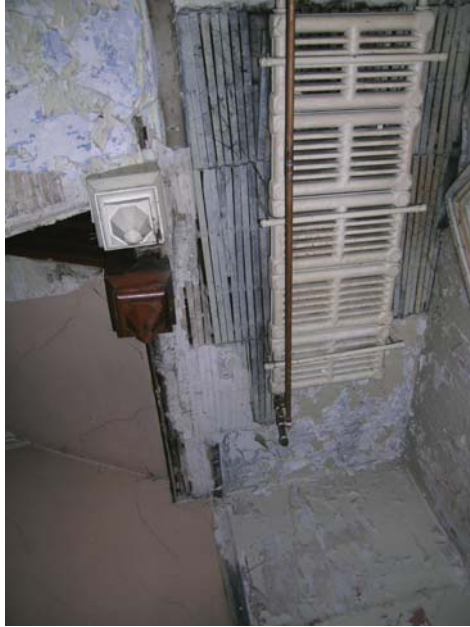
Plâtre défectueux au-dessus de l'entrée latérale (2004).
