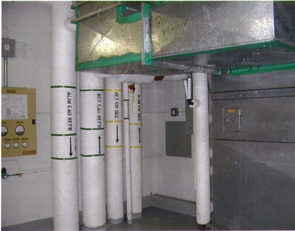
Photo 17 Vidéotron: Salle mécanique
