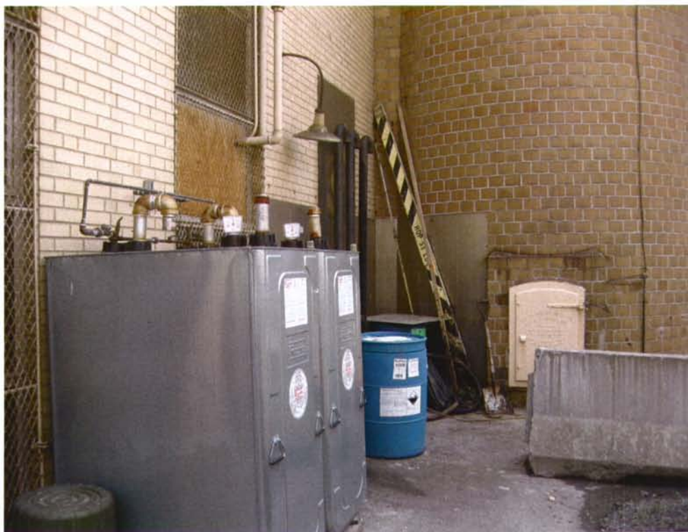
Photo 6: Hôpital Saint-Luc : Centrale thermique : 2 réservoirs hors-sol de 500 L pour l'alimentation des génératrices
