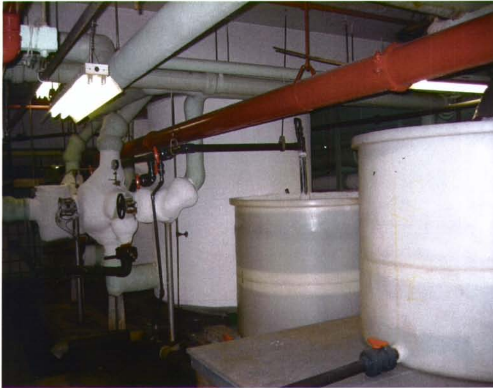
Photo 1: Hôpital Saint-Luc – Buanderie : Réservoir pour les adoucissants (sous-sol)
