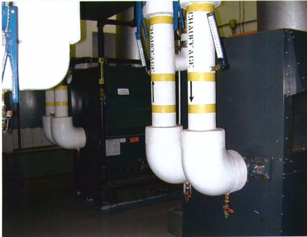
Photo 14 Vidétron: 2 fournaies situées au dernier étage du bâtiment
