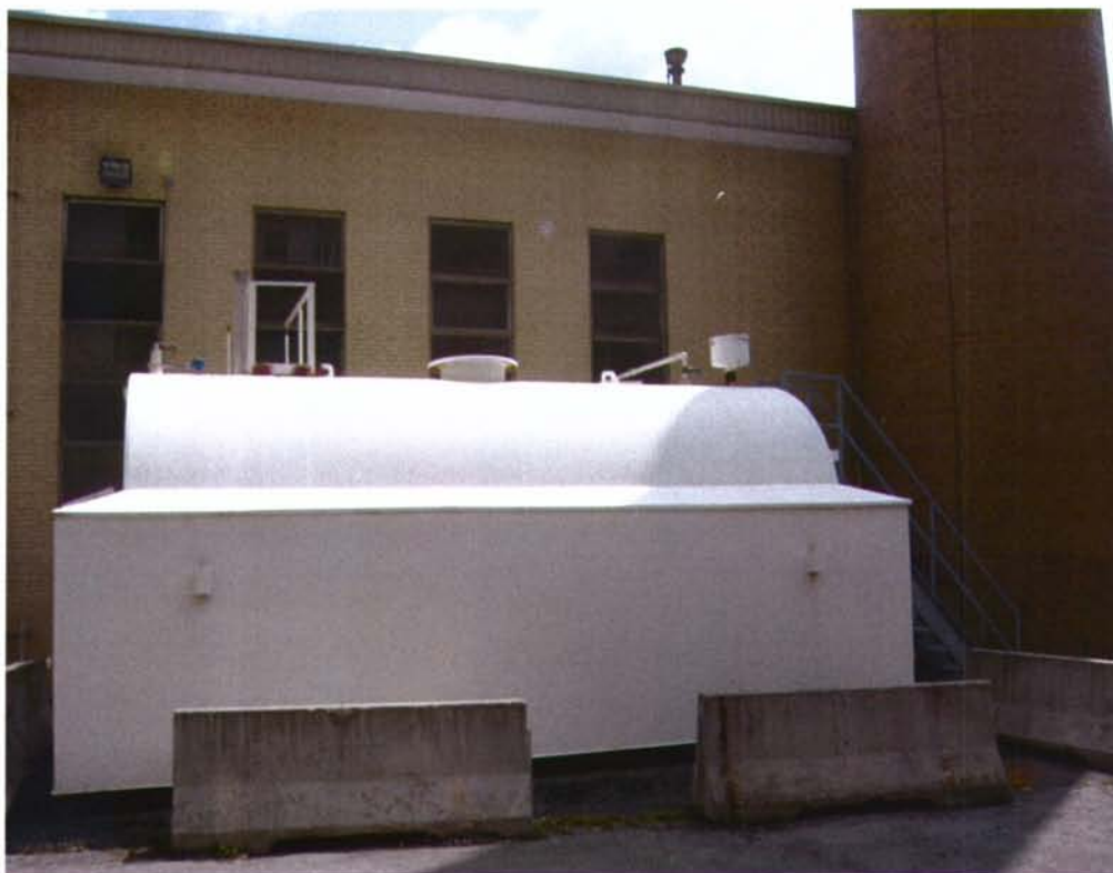
Photo 5: Hôpital Saint-Luc : Centrale thermique : réservoir hors-sol de 45 000 L servant à l'alimentation des chaudières
