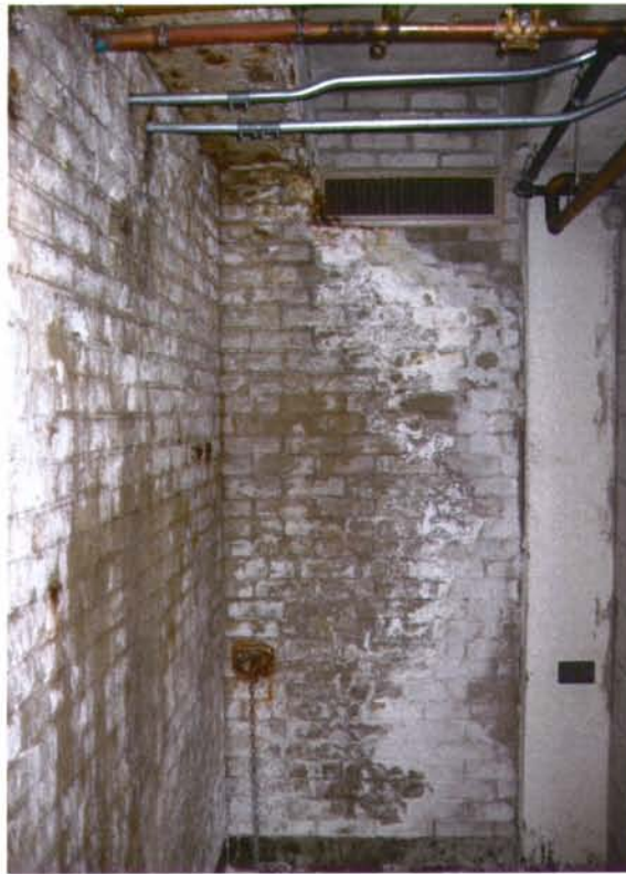
Photo 11: Hôpital Saint-Luc – Pavillon Principal : moisissure sur le mur d'une salle de la voûte anti-explosion
