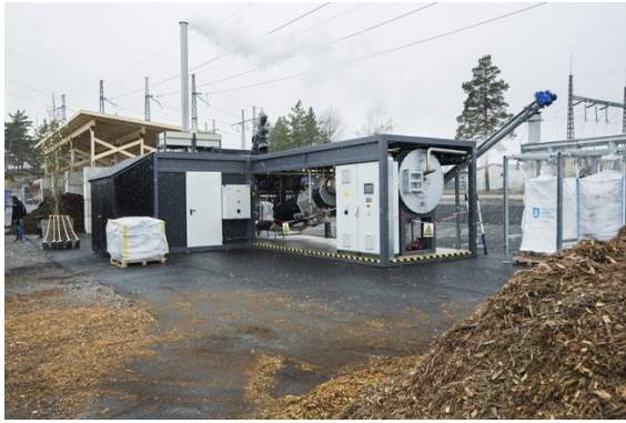
Photographe : Kari Kohvakka Usine de production de biochar
