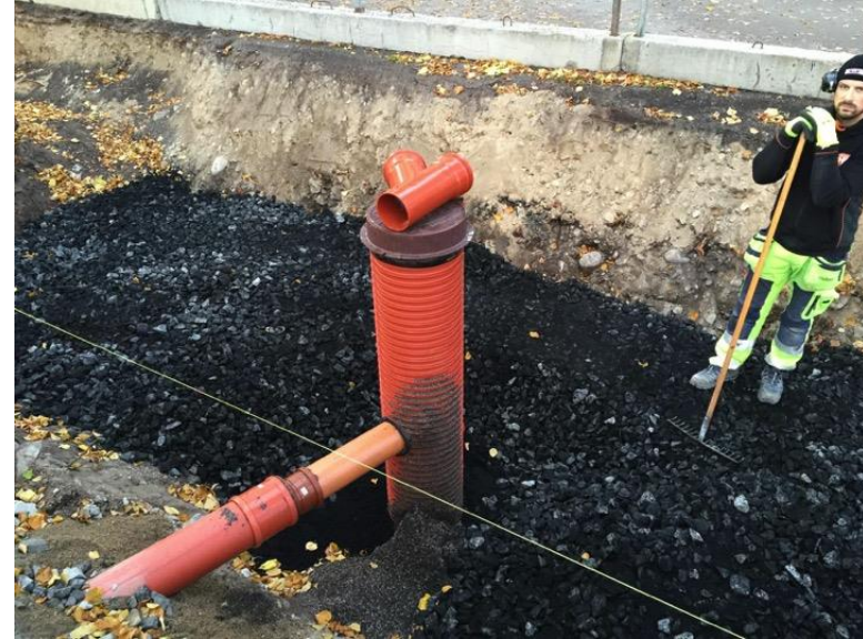
Préparation du lit de biochar pour la plantation d'arbres urbains à Stockholm
