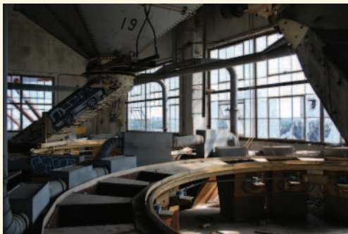
Machinerie à l'intérieur du silo n° 5. Photo : Ville de Montréal, 2019
