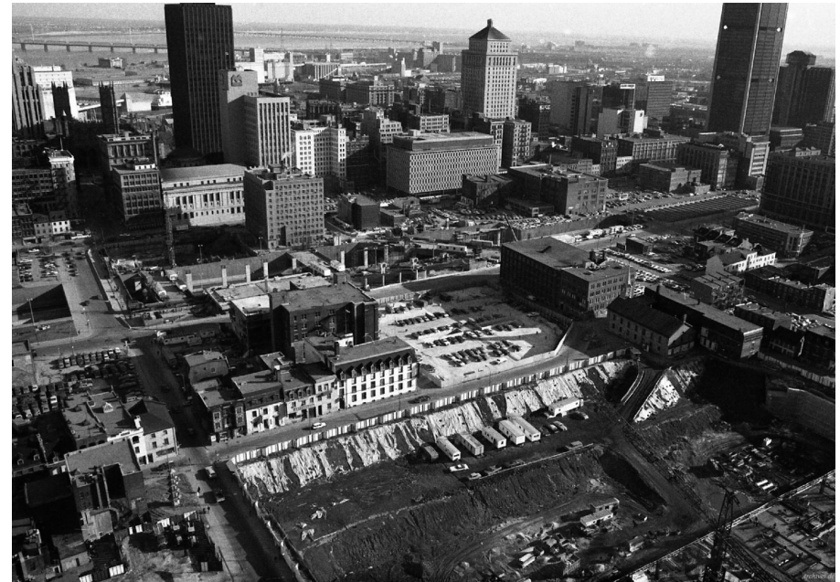
Fig. 4 Construction of the Complexe Guy-Favreau (Source: Phillippe Dumais / Archives de la Ville de Montréal)
