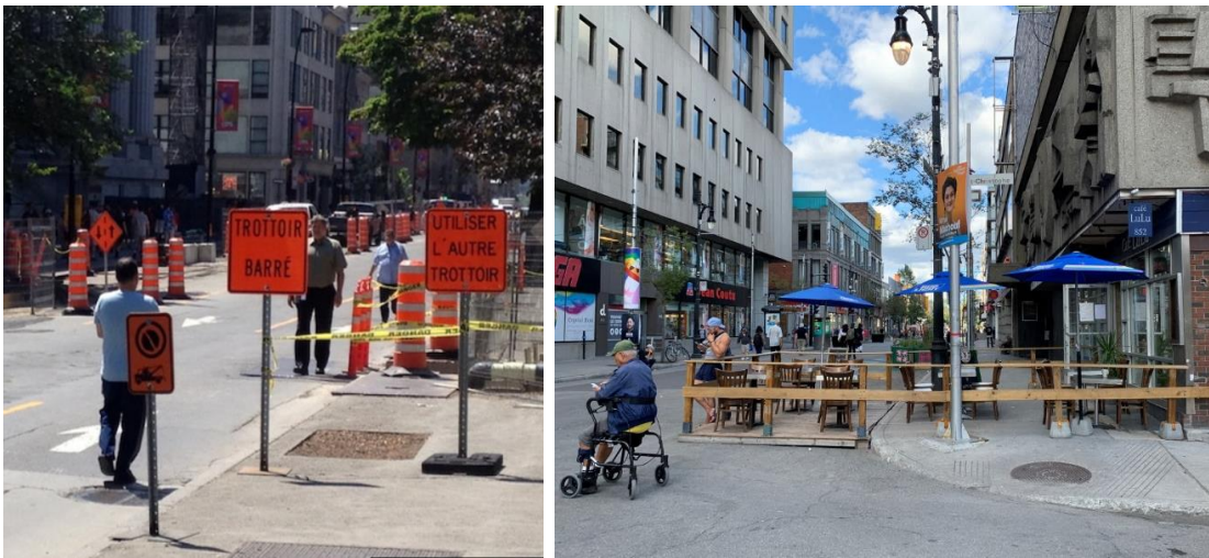
Image 3- Exemple d'un chantier n'offrant pas de corridor de marche protégé et accessible et d'un café-terrasse qui obstrue le trottoir et nuit à l'accessibilité des commerces
