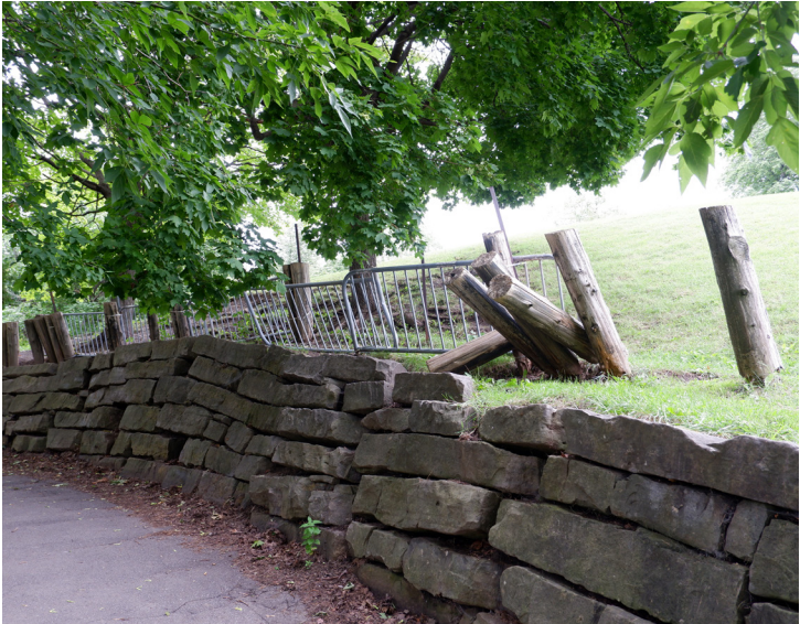
Mur de soutènement dégradé, enjeu de sécurité_Parc Beaubien
