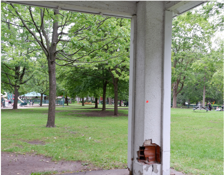
Chalet de parc en mauvais état_Parc Outremont
