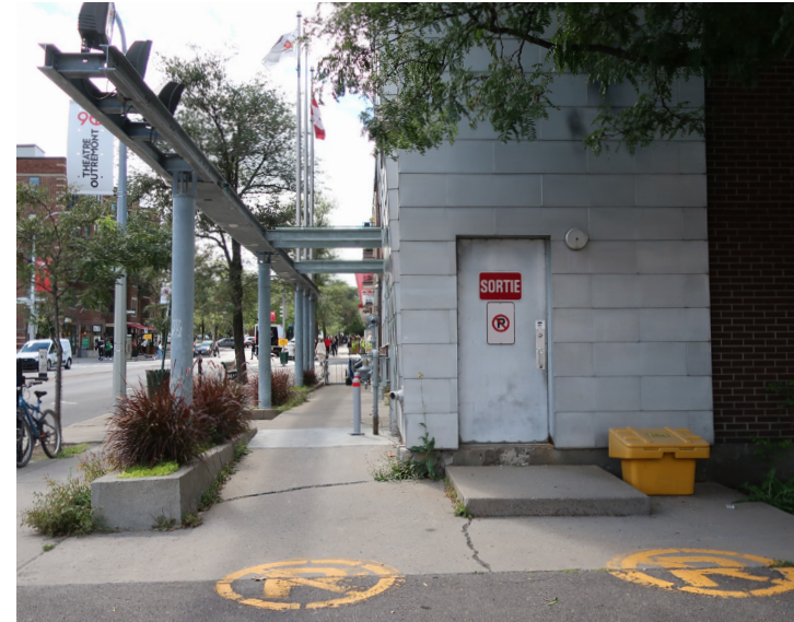
B_3 CPE / DATSA : béton fissuré sur la rampe d'accès à l'entrée principale
