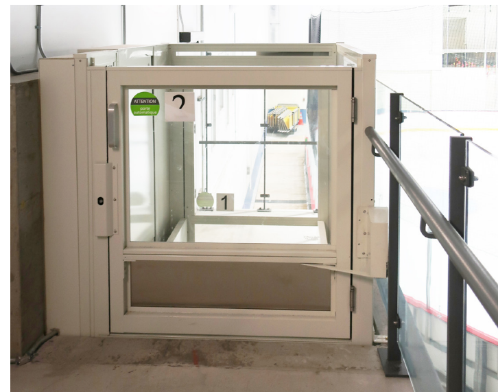
B_7 CCI : monte-personne pour l'accès universel aux gradins de l'aréna
