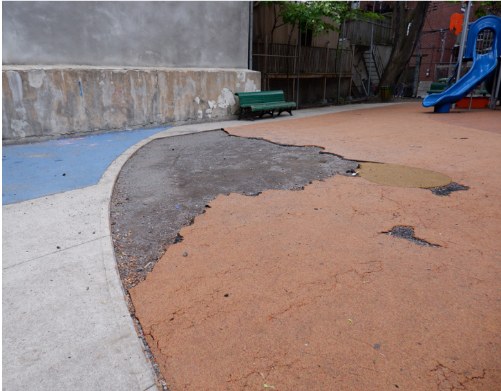
Surface amortissante de jeu défaillante_Miniparc Durocher
