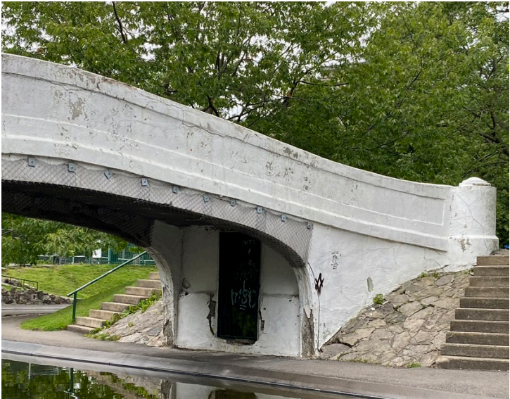
Parapet de l'infrastructure endommagé_Parc Saint-Viateur
