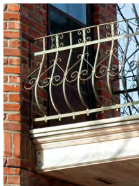
Garde-corps en acier et détails de fascia en bois avec plusieurs moulures.
