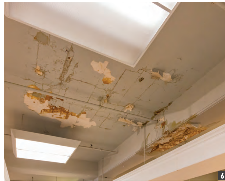
Détail des dégâts causés par l'infiltration d'eau (plafond du Colonial House)
