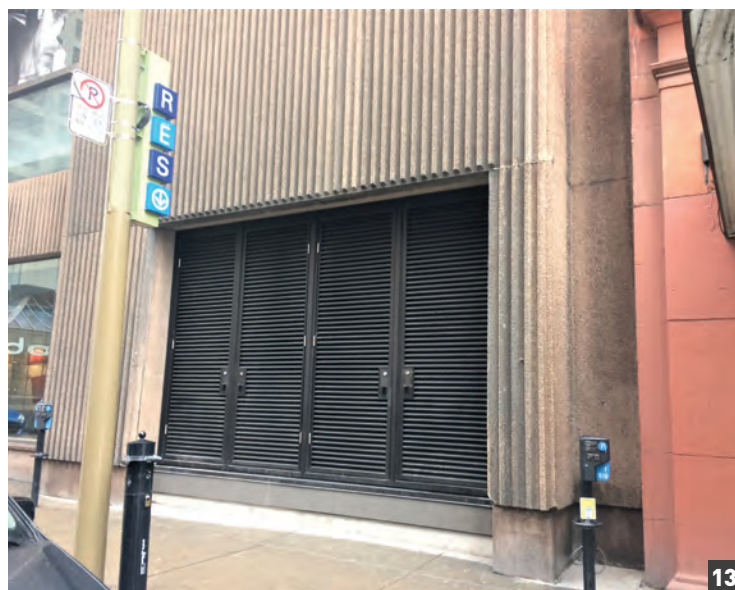
Persienne de ventilation du métro
