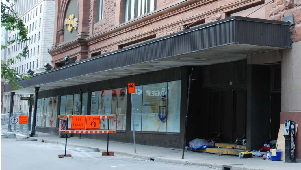
La marquise de la façade Aylmer. À noter l'absence de poteaux pour sa section la plus au nord.
