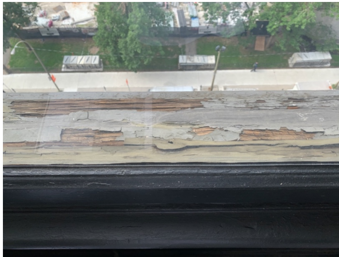
Les appuis sont en bois et nécessitent une intervention urgente de conservation.
