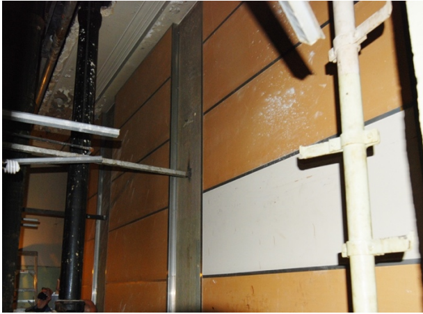
Baies situées derrière le bloc sanitaire obturées.
