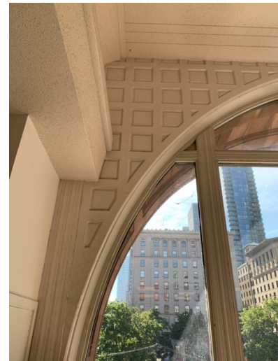
Détail de la baie centrale de la façade sud. Les menuiseries sont toujours présentes, le vitrage a cependant été remplacé par des unités scellées.
