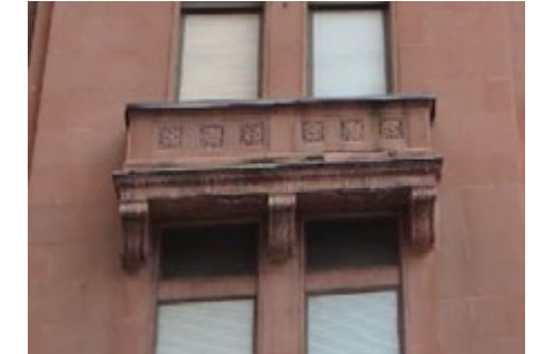
Balcons en pierre présentant des craques
