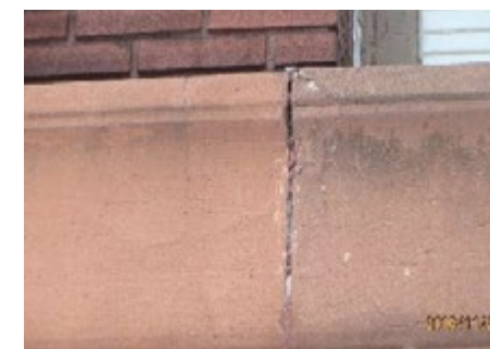
Joints ouverts et « microfissures »
