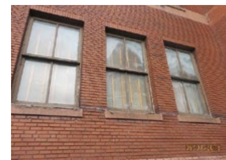
Dégradation des fenêtres de bois
