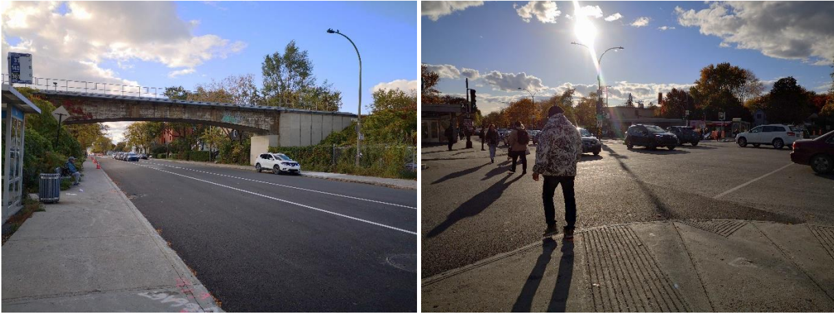
Figures 17 (gauche) et 18 (droite) : Construction d'une piste cyclable sur la rue Berri (REV) et piétons à la station Sauvé. Prise de vue : P. Viola.
